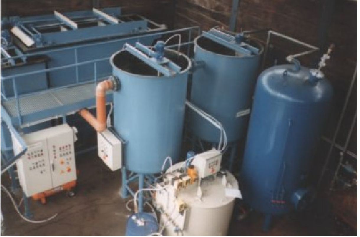
Şekil 3.9 Yer altı kaynak suları arıtım tesisi [1]
