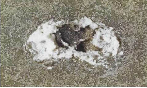
Şekil 5.15 İçerisinde bakır bulunan alüminyum alaşımında gözlenen çukurcuk korozyonu.[2]
