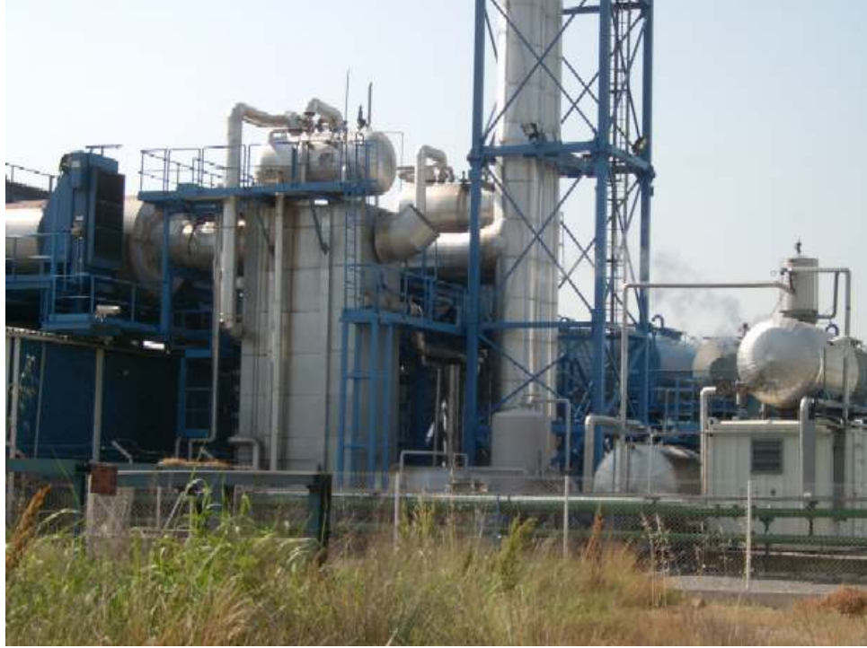
Şekil 5.5 Çayırova Enerji Santrali atık ısı kazanları
