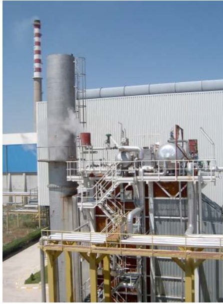
Şekil 4.6 Sistemdeki gaz türbinleri atık ısı kazanları
