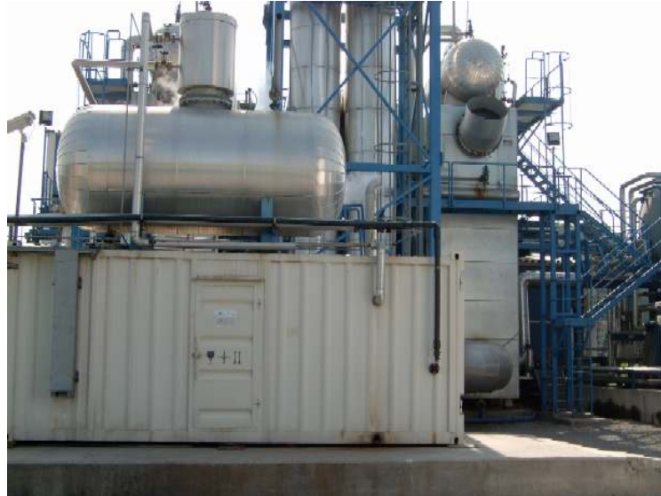
řekil 6.1 Kojenerasyon tesisindeki flaş buhar konteynırı
