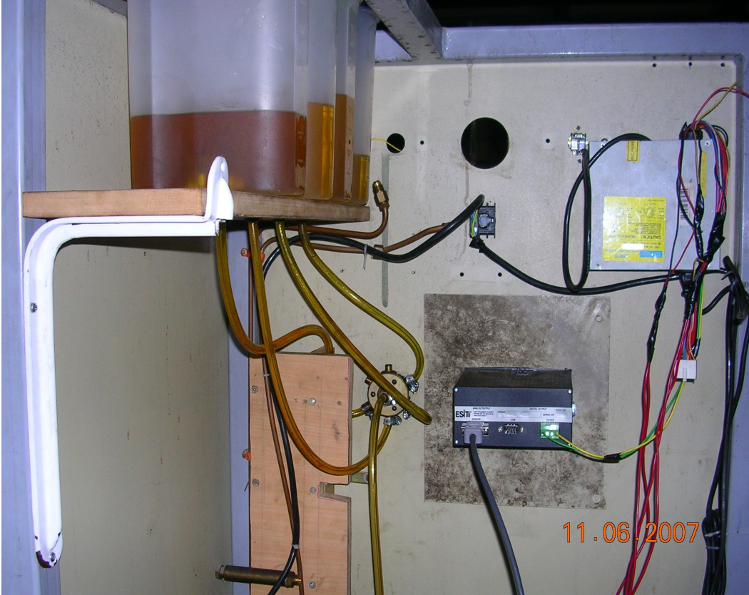
Şekil 5.7. Yakıt Tankları ve 5 Yollu Vananın Genel Görünümü
