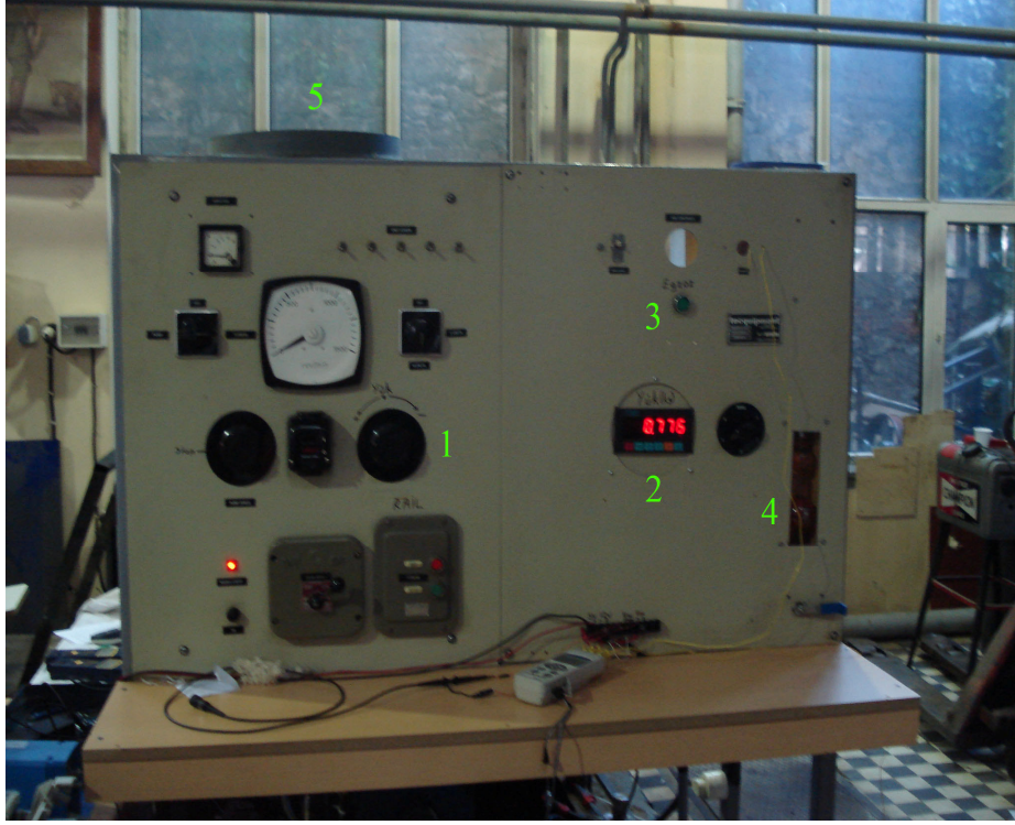
Şekil 4.8 Kontrol paneli genel görünümü
