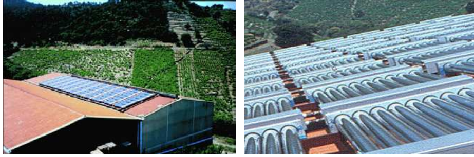
Şekil 2. 9 Fransa'daki şarap mahzeninin ve kurulu güneş enerjisi sisteminin görünüşü
