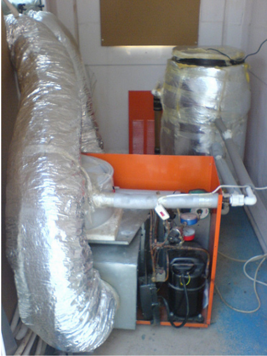
Şekil 14.11 Isı Pompası ünitesi, Su deposu ve hava kanalları
