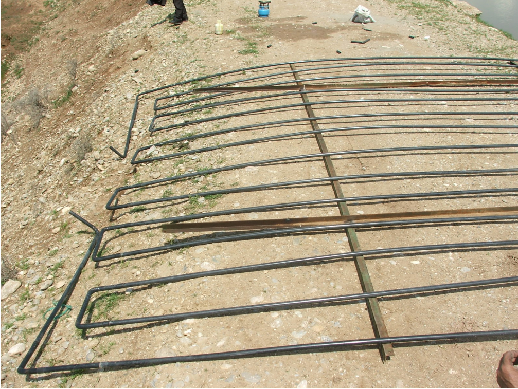
Resim 5.7 : Tesisatın genel görünümü
