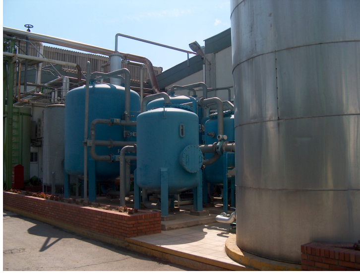
Şekil 6.1 Kondens tankı (sol tarafta büyük mavi tank)
