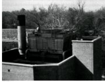
Şekil 4.15 Soğutma kulesi (Bradshaw, 1993)
