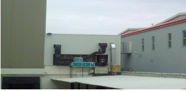
Şekil 2. 11 Temiz Oda Klima Santrali
