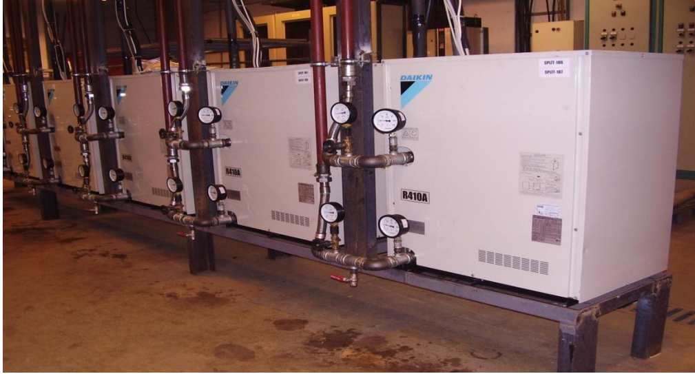
Şekil 6.6 Örnek Su soğutmalı VRV dış ünite uygulaması
