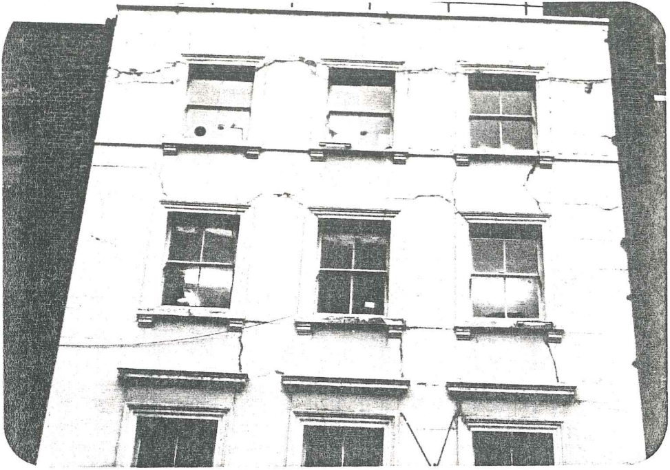
F.23-Zemin Oturmasından Oluşan Çatlaklar
