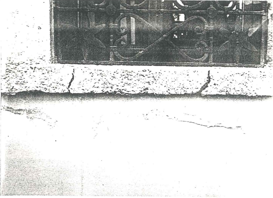
Res.105. Rutubet etkisi sonucu oluşan çatlamlar (Şeyh Murat Efendi Tekkesi)
