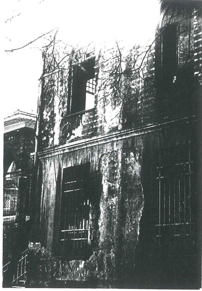
Resim 4.15 Mektebin avlu cephesindeki bozulmalar.
