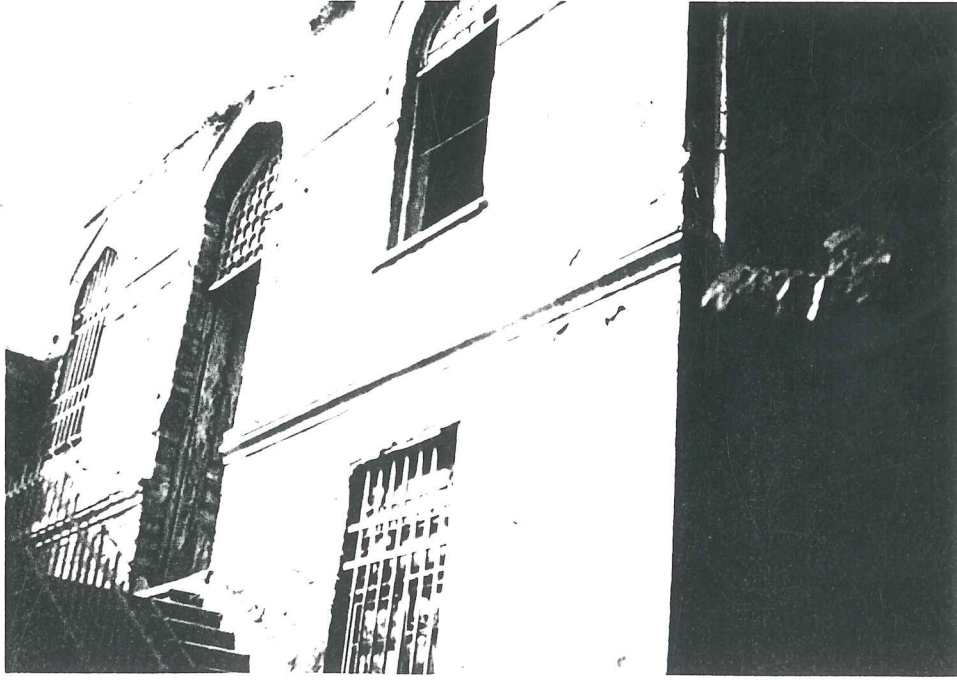
Resim 4.16 Mektebin giriş cephesindeki bozulmalar.
