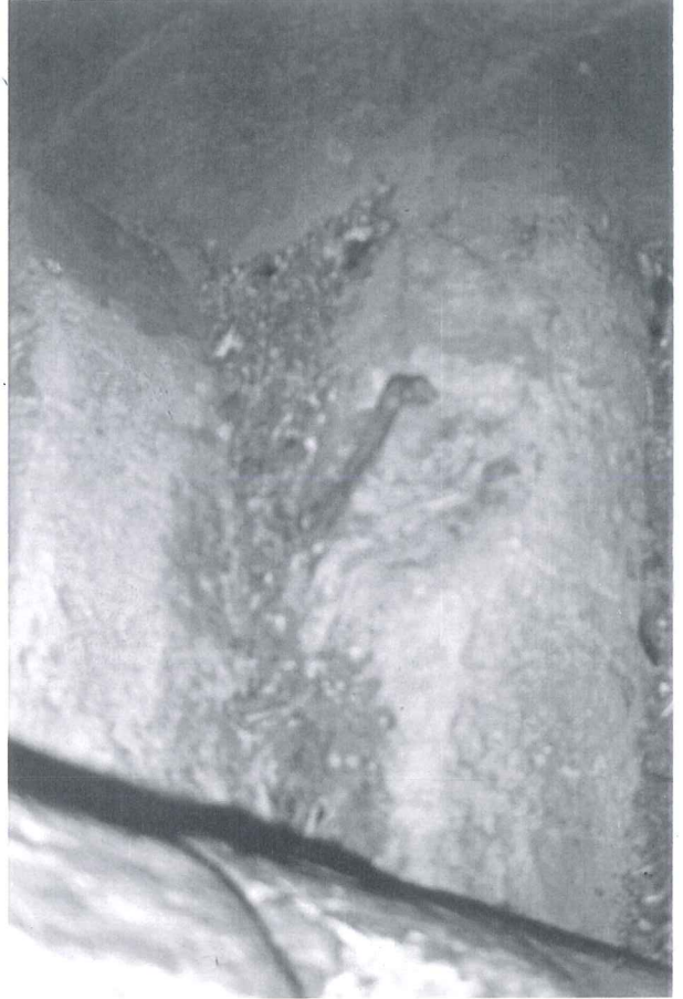
R.50. Basamak ve çekirdek bölümündeki bozulma.
