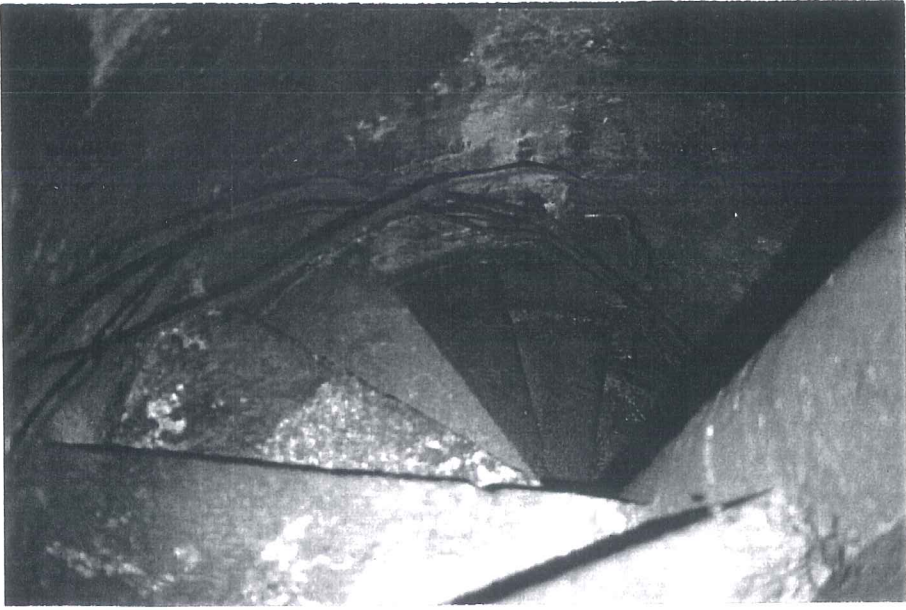
R13. Merdiven basamaklarının alt yüzeylerindeki bozulmalar.
