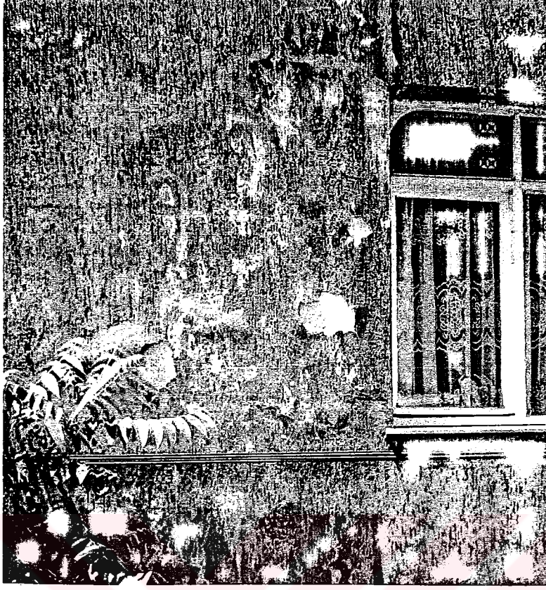
Resim 4.19 Duvar bünyesine giren suyun oluşturduğu çiçeklenme olayı sonucu dış yüzeyde meydana gelen beyaz lekelenmeler, kabarma ve dökülmeler.
