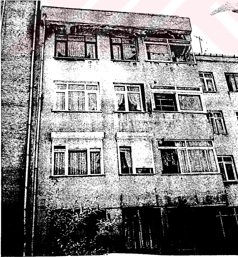
Resim 4.12 Teras çatının hatalı uygulama ve malzeme seçimi sonucu suyu alt döşemeye ve duvar bünyesine geçirmesi ile ortaya çıkan beyaz lekelenmeler, kabarma ve dökülmeler.
