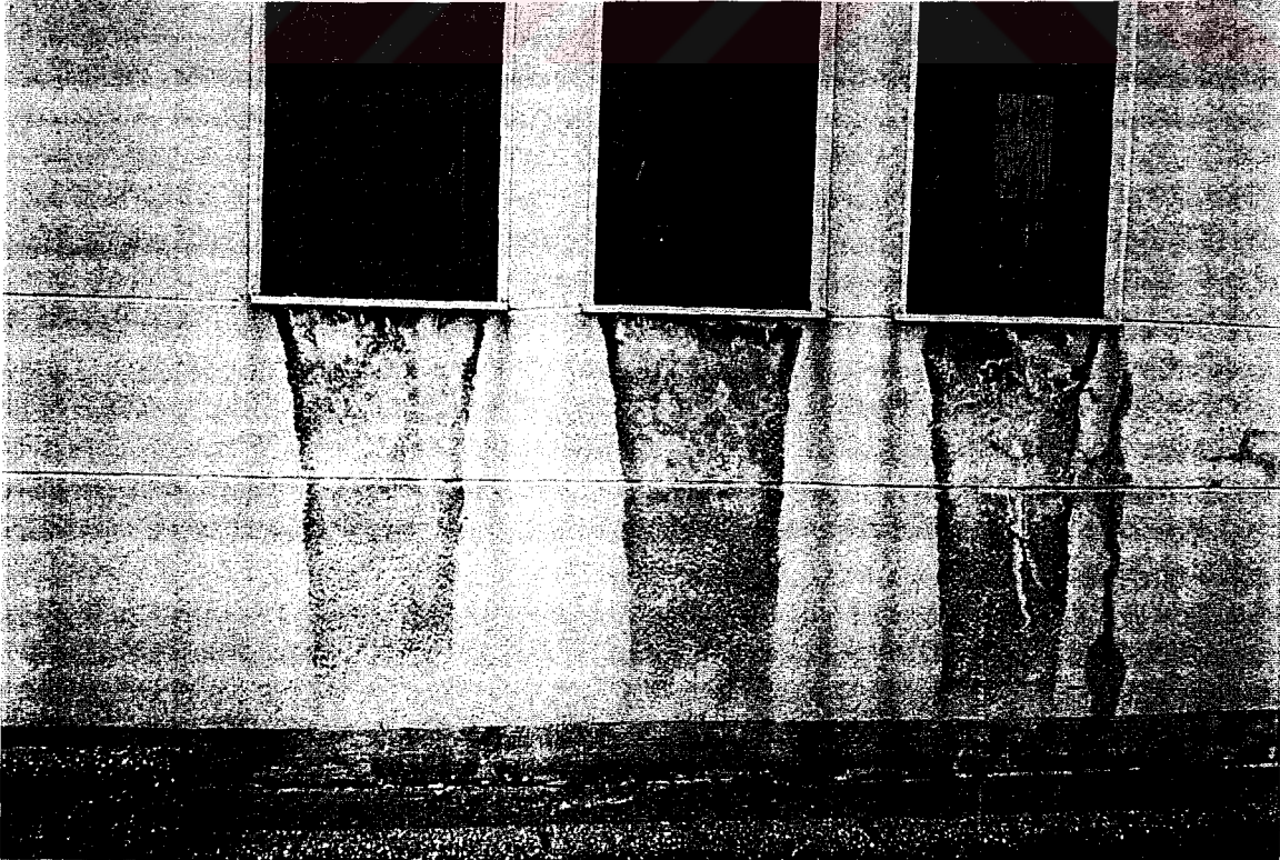
Resim 4.28 Yağmur suyuna bağlı dış yüzeyde görülen kirlenme ve lekelenmeler.
