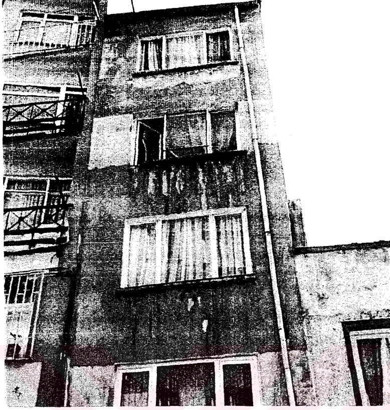
Resim 4.26 Yağmur suyuna bağlı dış yüzeyde görülen kirlenme ve lekelenmeler.
