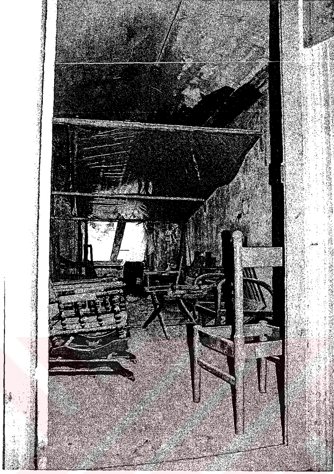
Resim 4.100 402 no'lu mekanın bozulmuş tavanı.
