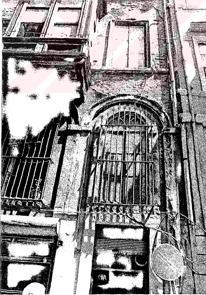
Resim 4.133 Binanın ön cephesi birinci katta bulunan metal pencere parmaklıkları.
