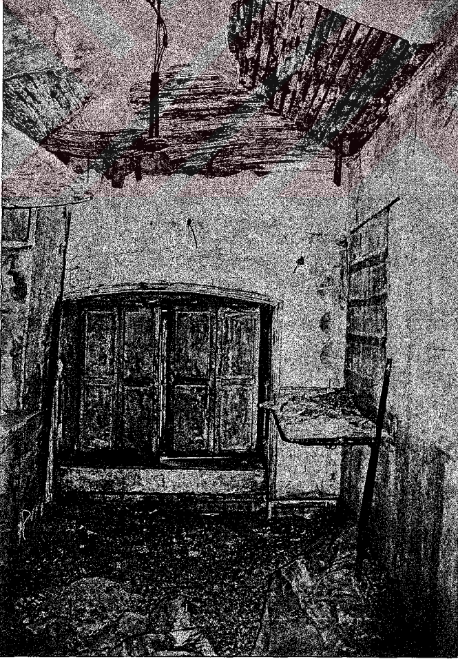
Resim 4.111 406 no'lu mekanın bozulmuş tavanı ve sıvaları dökülmüş duvarı.
