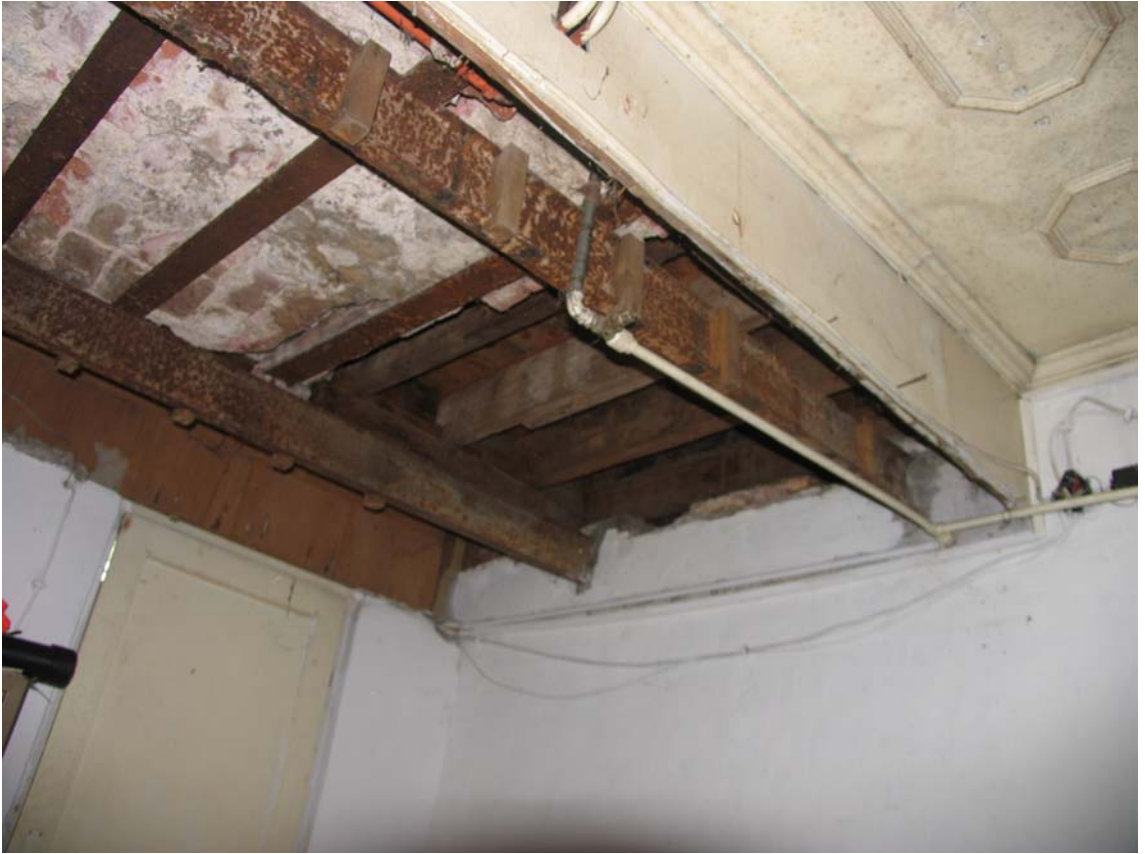
Resim 4.77 Odanın tavanındaki bozulmalar
