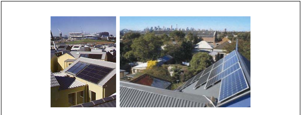
Şekil 4. 36 Çatıda Fotovoltaik uygulamaları [13]
