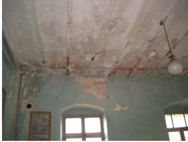
Şekil 6.53 101 sınıf mekanı voltalarının bugünkü durumu, paslanmış putreller.
