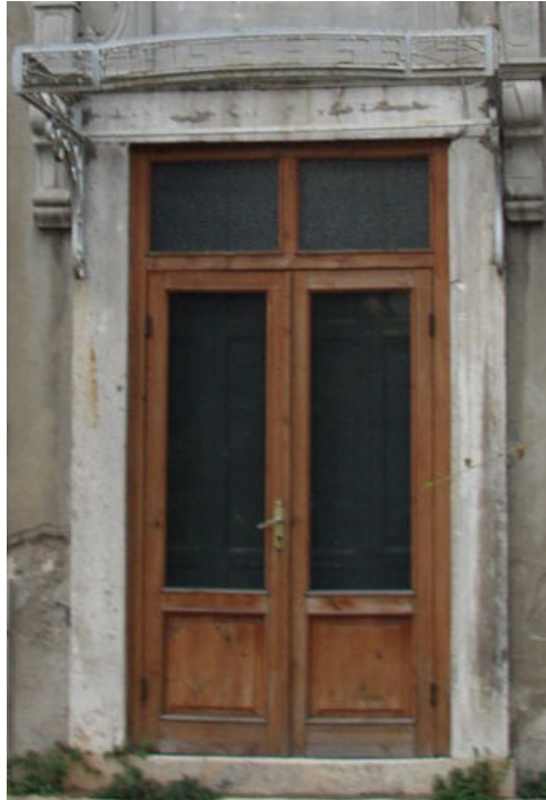
Şekil 6.47 Metal giriş kapısının önüne sonradan eklenen ahşap kapı.
