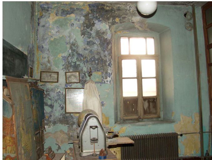
Şekil 6.36 Mekanın dış duvarlarında oluşmuş rutubet problemi.
