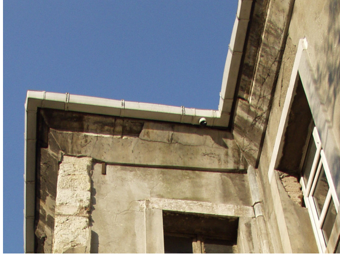
Şekil 6.89 Yağmur oluğu ve köşe noktalardan inen yağmur iniş borusu.
