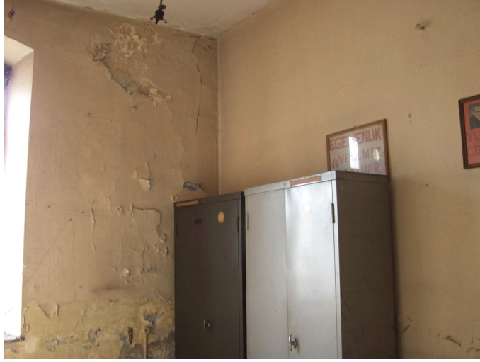
Şekil 6.25 Z02 mekanının rutubetten kabarmış duvar sıvaları.
