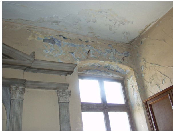
Şekil 6.30 Z04 mekanında görülen yoğun rutubet problemi.
