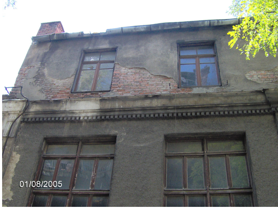
Şekil 4.12 Kuzeydoğu Cephesi, ek çimento sıva yapılan bölgeler.ç
