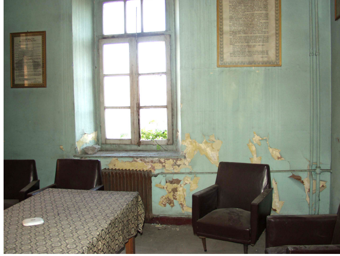
Şekil 6.33 Z05 Mekanının duvarlarında oluşmuş rutubetten kaynaklanan sıva dökülmeleri.
