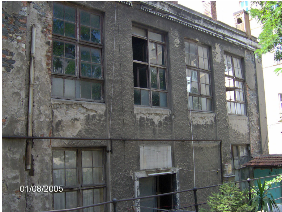
Şekil 4.11 Kuzeydoğu Cephesi'nde görülen sıva dökülmeleri ve bozulmalar
