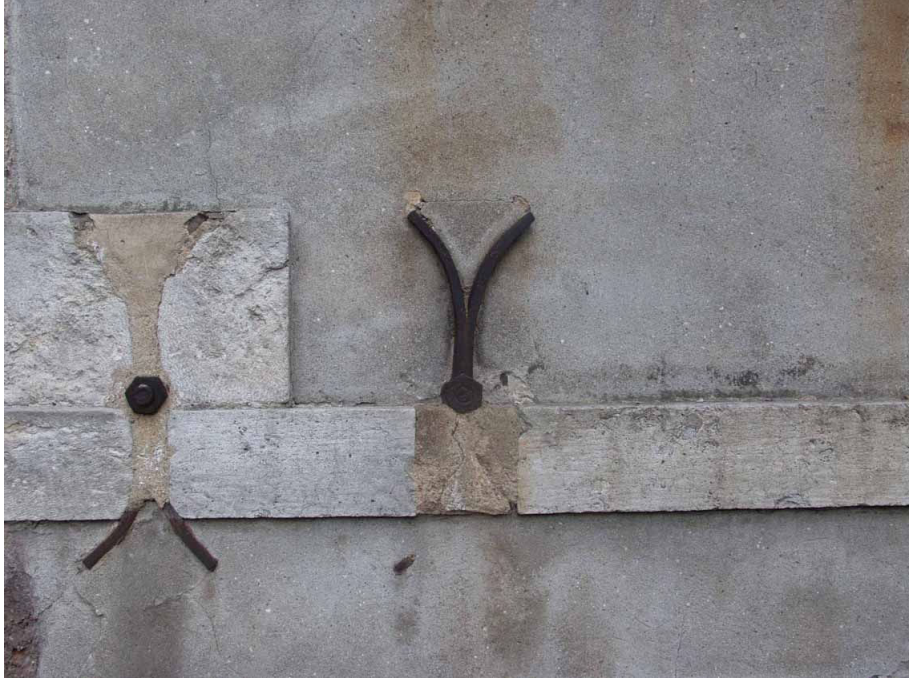
Şekil 6.92 Metal elemanlarda paslanma.
