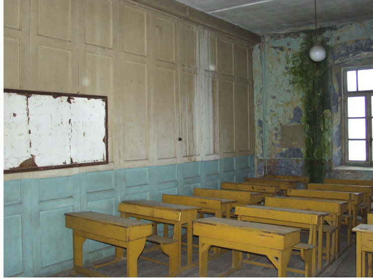
Şekil 6.57 Ahşap bölme ve yoğun rutubete maruz kalmış duvar.
