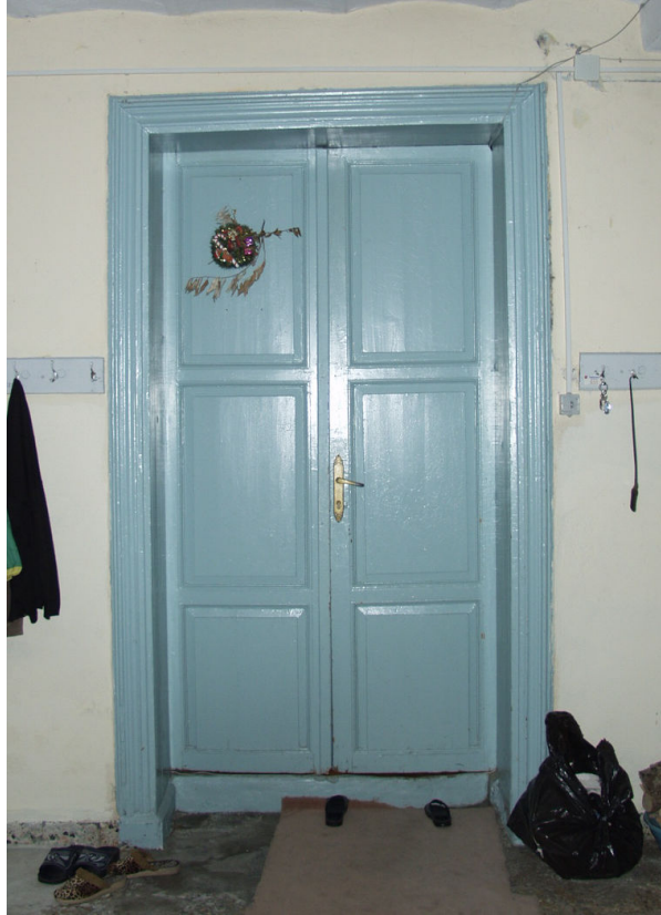
Şekil 6.5 B07 Mekanı, özgün ahşap giriş kapısı.
