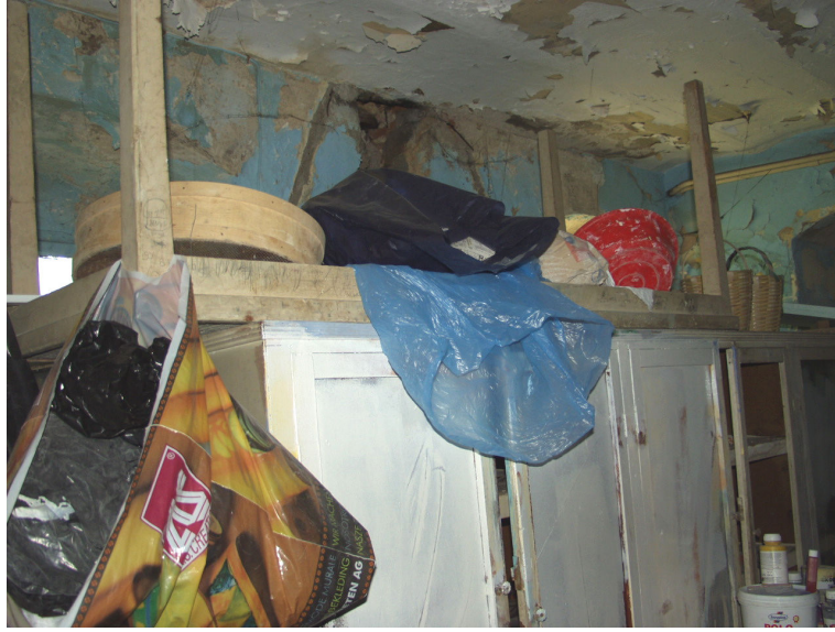
Şekil 6.9 B11 mutfak mekanı, baca izi.
