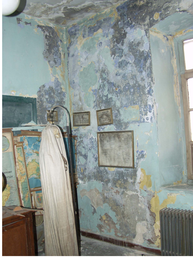
Şekil 6.37 Sıva şişmesi ve dökülmeler.
