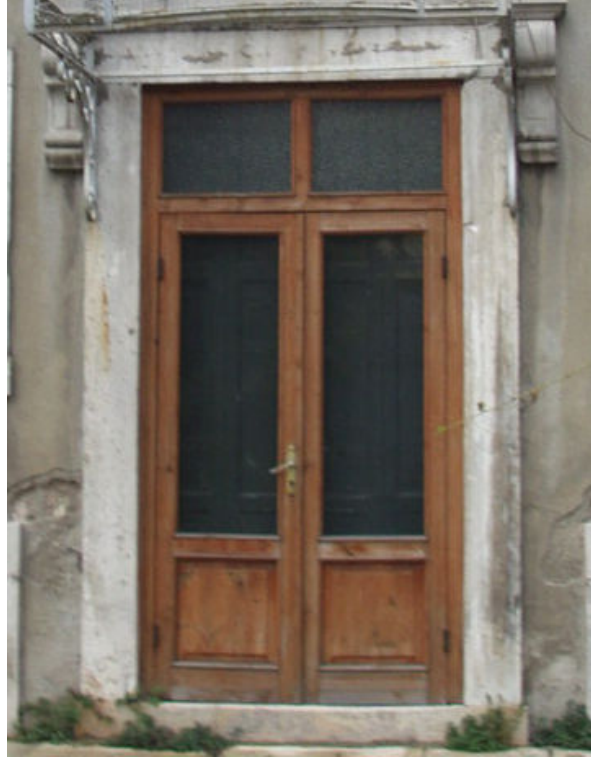
Şekil 6.84 Giriş kapısının önündeki muhdes ahşap kapı.
