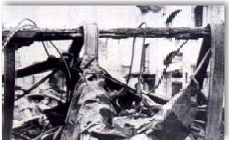
Resim 2.1 Bir yangın sonunda çelik malzemenin erimesi sonucu altındaki ahşap kiriş tarafından taşınması
