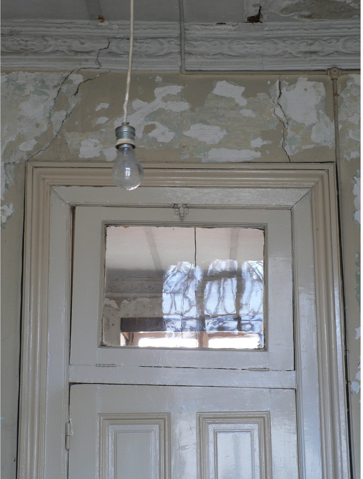
Ek 1 Şekil 14 Kapı üzerinde çatlamlar
