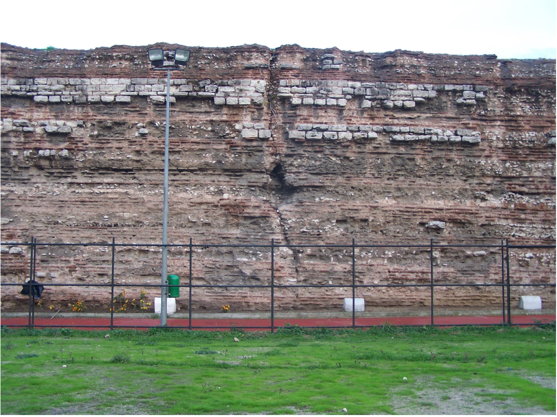
Şekil 4.75 Doğu duvarının iç cephesindeki kuzeyden itibaren 2. çatlak (2007)
