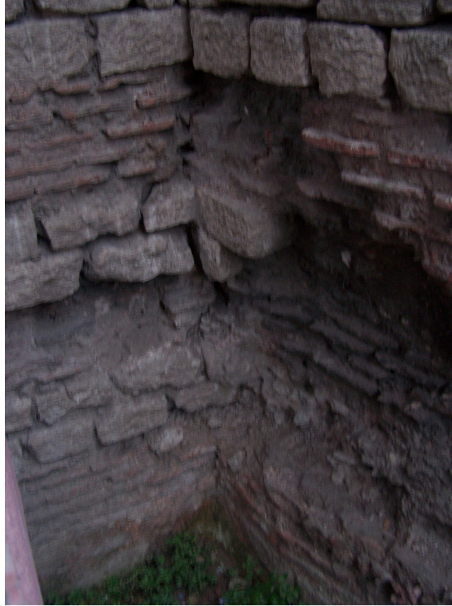
Şekil 5.4 Güneybatı köşedeki destek duvarında oluşan çatlağın alt kısmı (2007)
