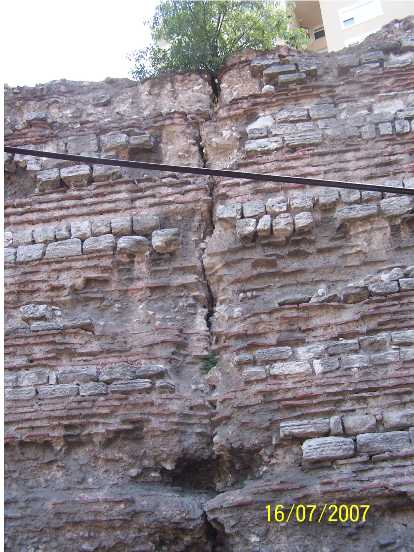
Şekil 5.15 Çatlaklar içinde köklü bitki oluşumu (2007)
