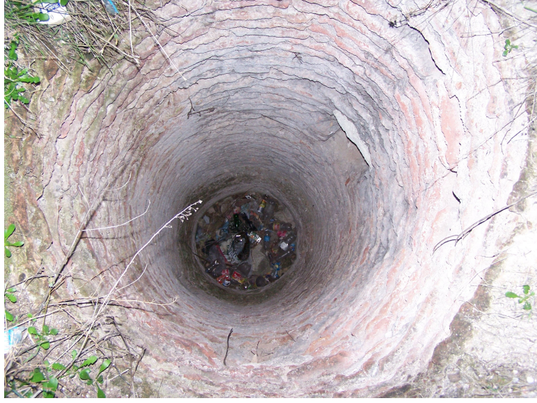
Şekil 4.66 Merdivenin tuğla duvarının moloz ve çöp dolgulu iç boşluğu (2007)
