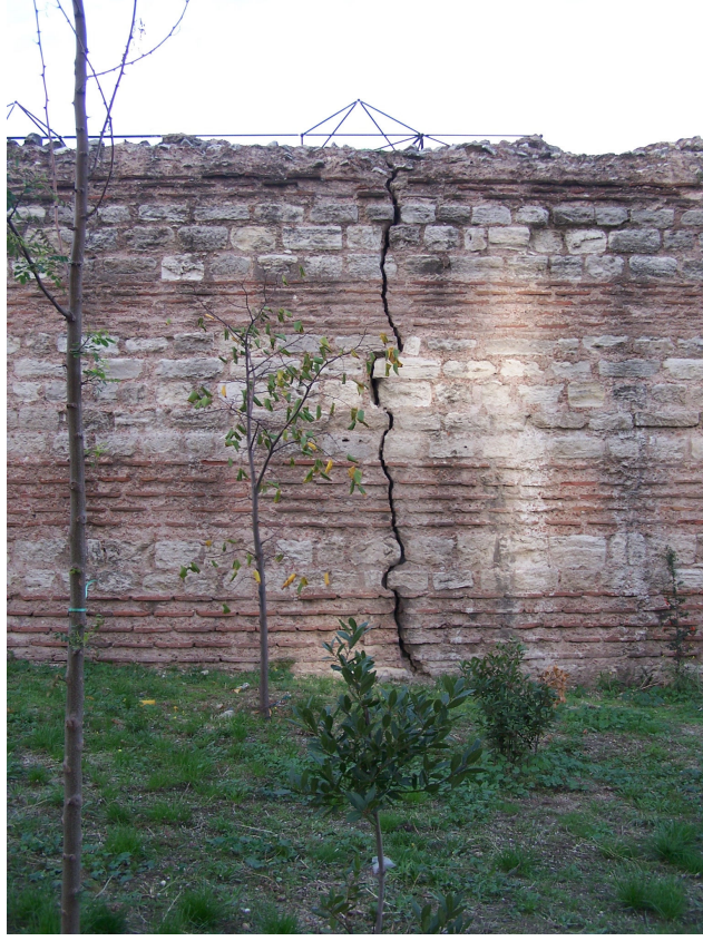
Şekil 4.93 Güney duvarının dış cephesindeki doğudan itibaren 2. çatlak (2007)
