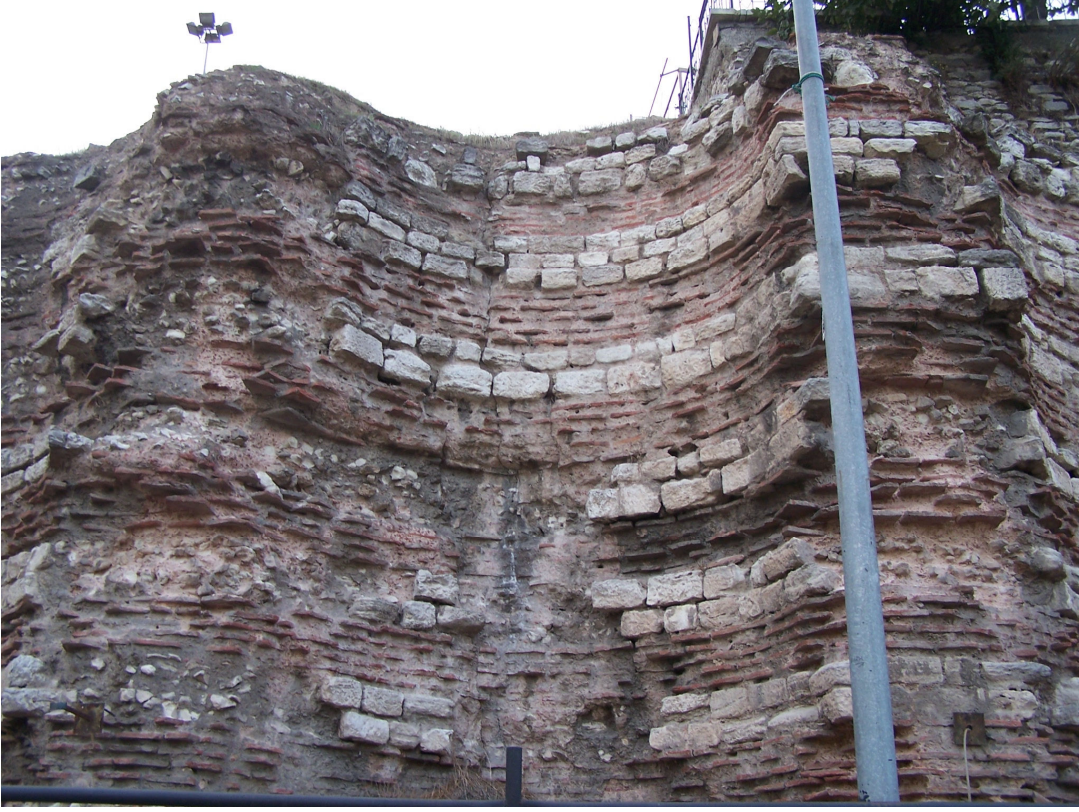
Şekil 4.110 10. nişte tespit edilen kuzey köşeden itibaren 2. çatlak (2007)
