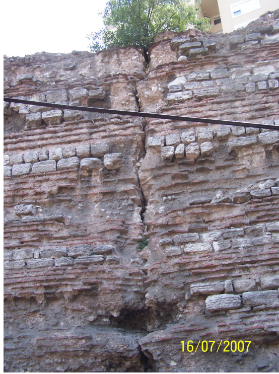
Şekil 4.91 Güney duvarının iç cephesindeki batıdan itibaren 1. çatlak (2007)
