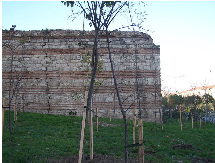
Şekil 4.92 Güney duvarının dış cephesindeki doğudan itibaren 1. çatlak (2007)
