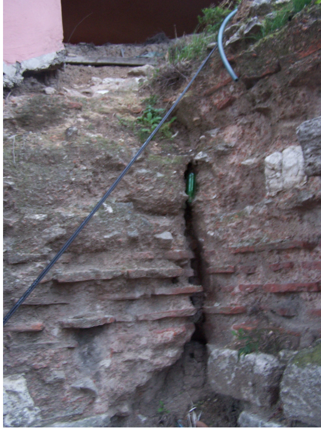
Şekil 5.3 Güneybatı köşedeki destek duvarında oluşan çatlağın üst kısmı (2007)
