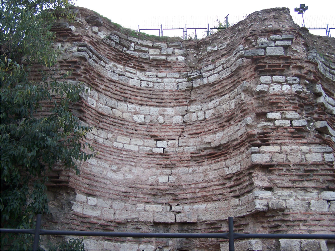
Şekil 4.112 17. nişte tespit edilen kuzey köşeden itibaren 4. çatlak (2007)
