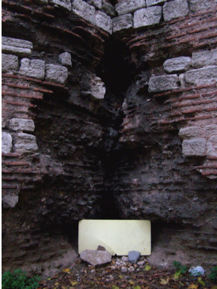
Şekil 5.14 Güneydoğu köşesindeki destek duvarının batı duvarı ile arasında zemine yakın kısımdaki malzeme kaybı (2007)
