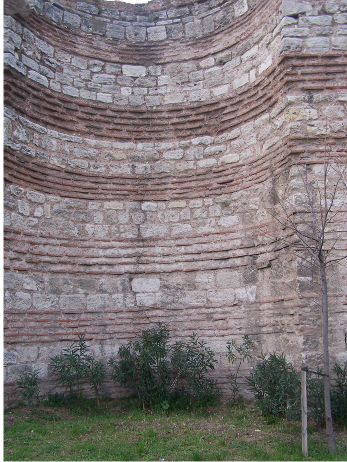
Şekil 4.78 Doğu duvarının dış cephesindeki 8. nişin orta aksındaki çatlak (2007)
