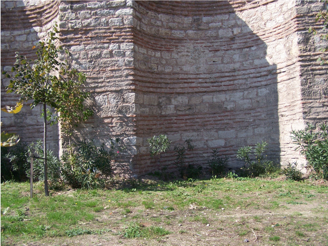
Şekil 4.68 Doğu duvarının dış cephesindeki tuğla sıralarında zemine doğru kayma (2007)
