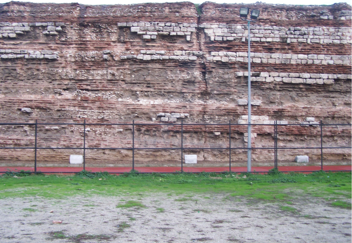
Şekil 4.76 Doğu duvarının iç cephesindeki kuzeyden itibaren 3. çatlak (2007)
