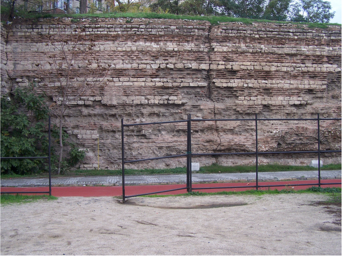
Şekil 4.45 Kuzey duvarının iç cephesinde doğudaki 1. çatlak (2007)
