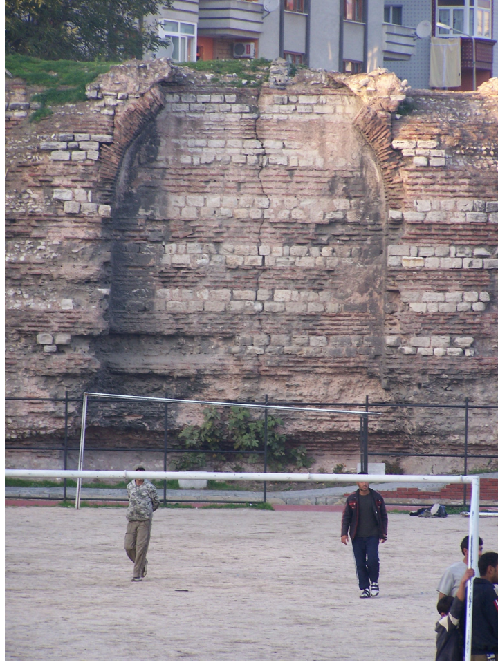
Şekil 4.46 Kuzey duvarının iç cephesindeki 2. çatlak (2007)
