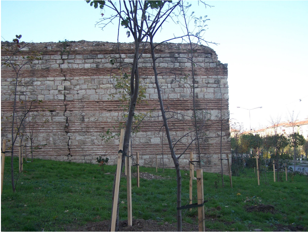
Şekil 5.17 Güney duvarının dış cephesindeki çatlak (2007)
