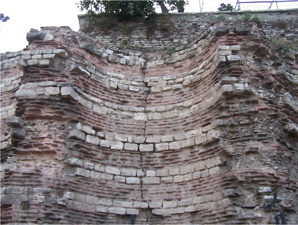
Şekil 4.109 9. nişte tespit edilen kuzey köşeden itibaren 1. çatlak (2007)
