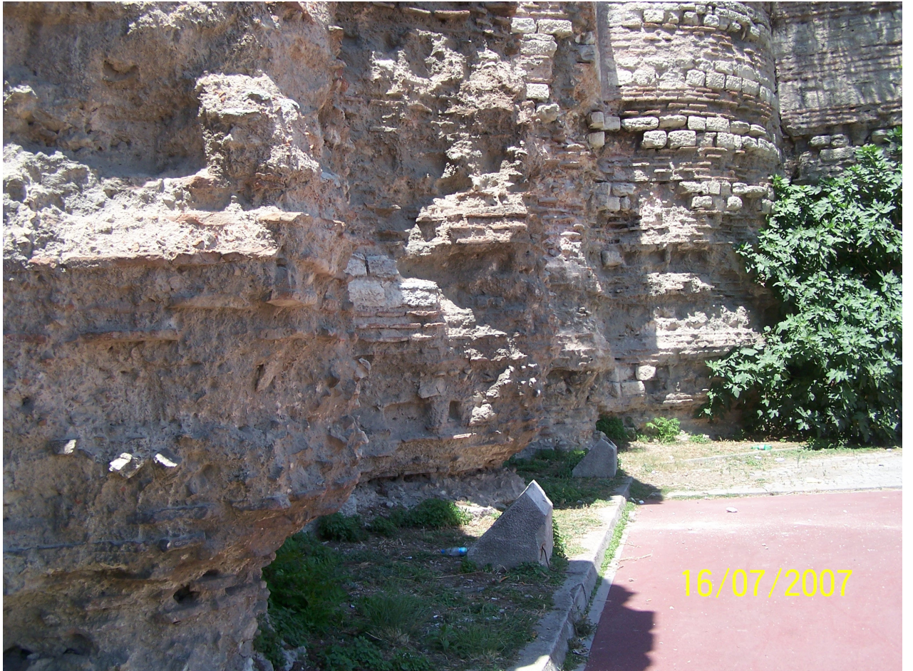
Şekil 5.1 Batı duvarının iç cephesinde niş duvarlarındaki malzeme kaybı (2007)
