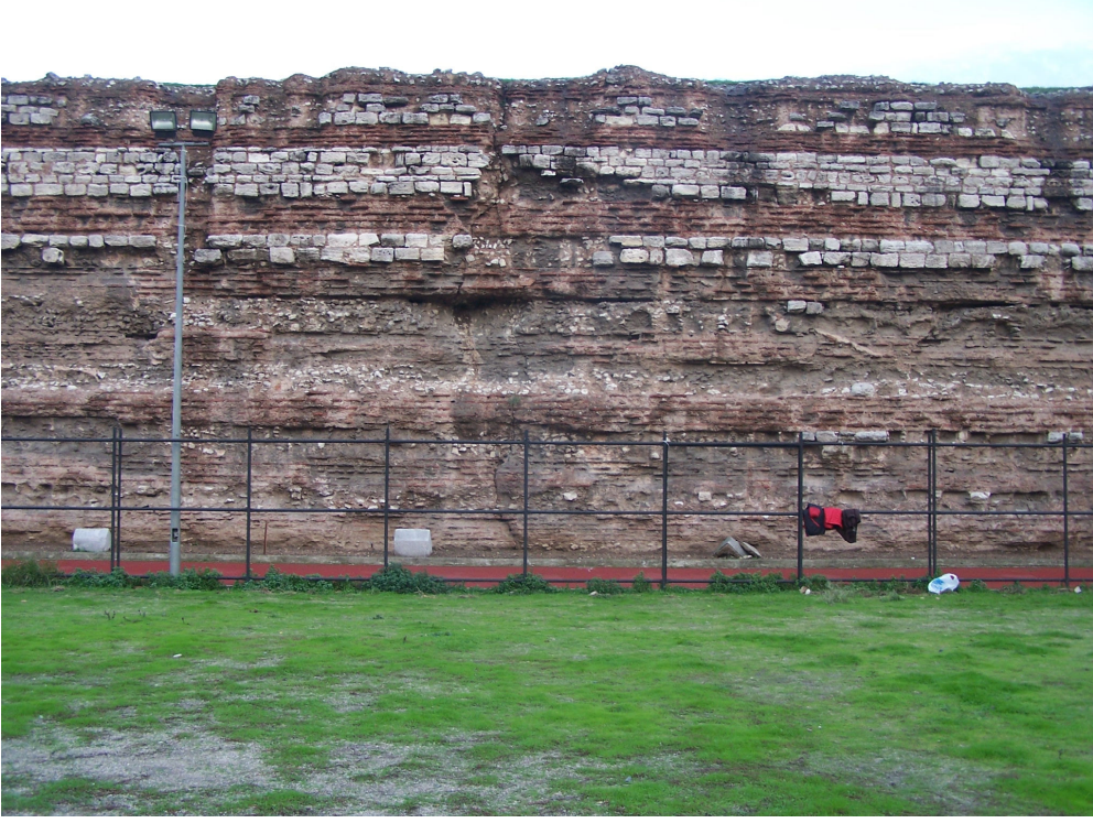
Şekil 4.77 Doğu duvarının iç cephesindeki kuzeyden itibaren 4. çatlak (2007)
