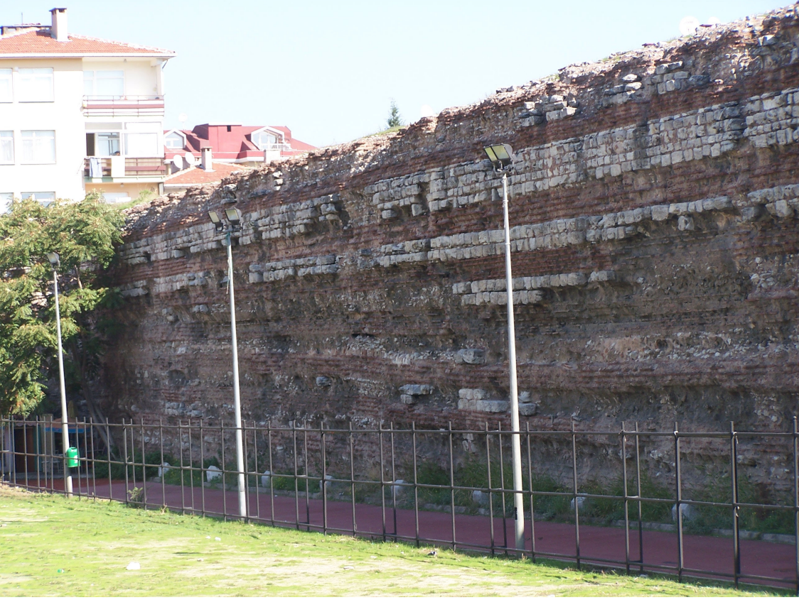
Şekil 4.56 Doğu duvarının iç cephesindeki tuğla sıralarında zemine doğru kayma (2007)
