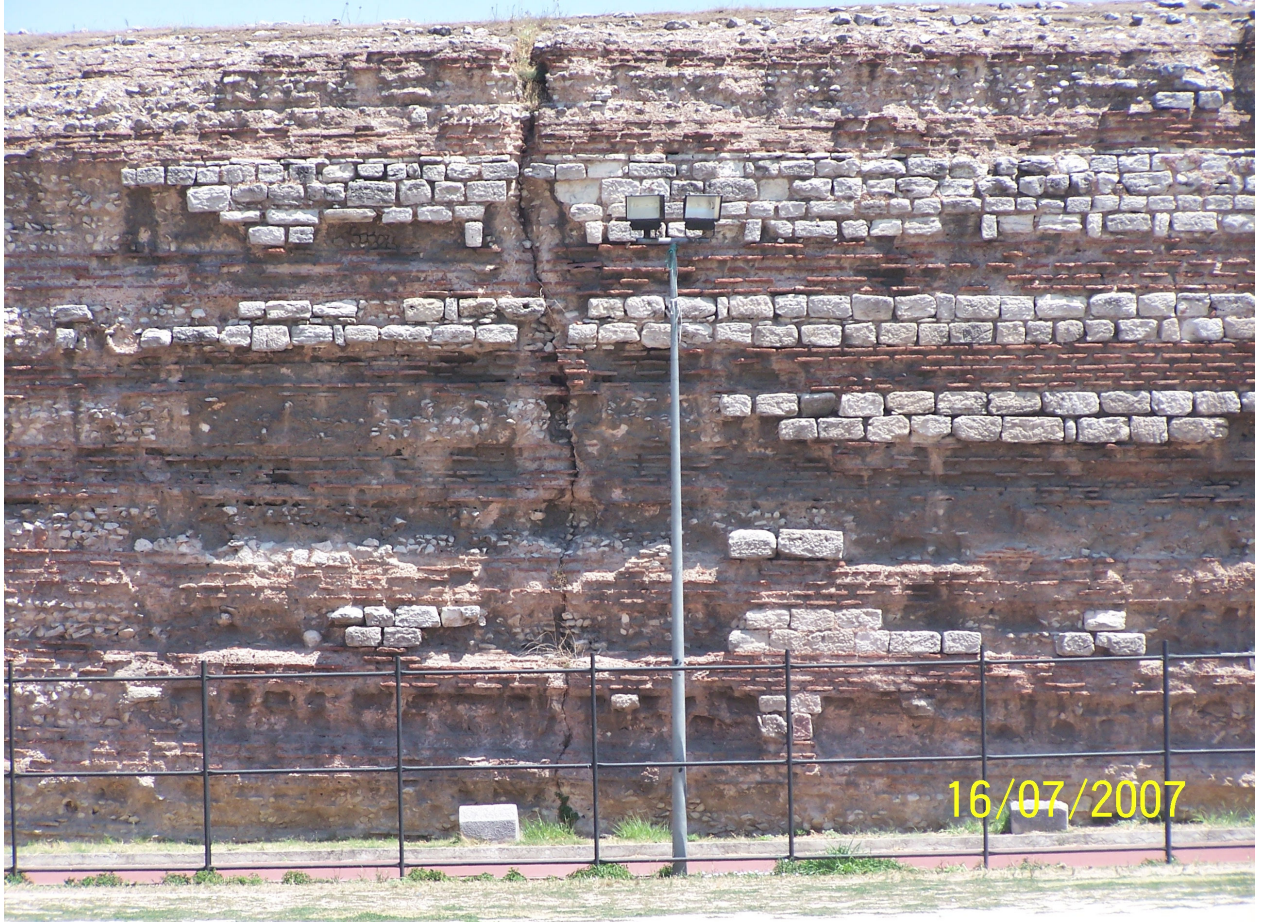
Şekil 5.2 Doğu duvarının iç cephesindeki taş ve tuğla malzeme kayıpları (2007)
