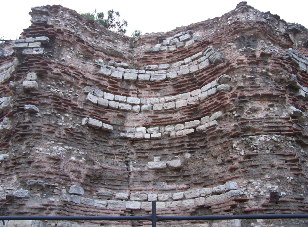
Şekil 4.111 14. nişte tespit edilen kuzey köşeden itibaren 3. çatlak (2007)
