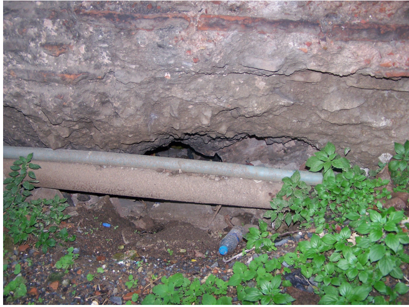
Şekil 4.53 Doğu duvarının iç cephesindeki kanal ağzı (2007)
