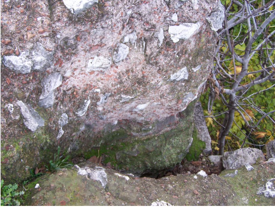
Şekil 5.13 Güneydoğu köşesindeki destek duvarının batı duvarı ile arasında oluşan çatlak (2007)
