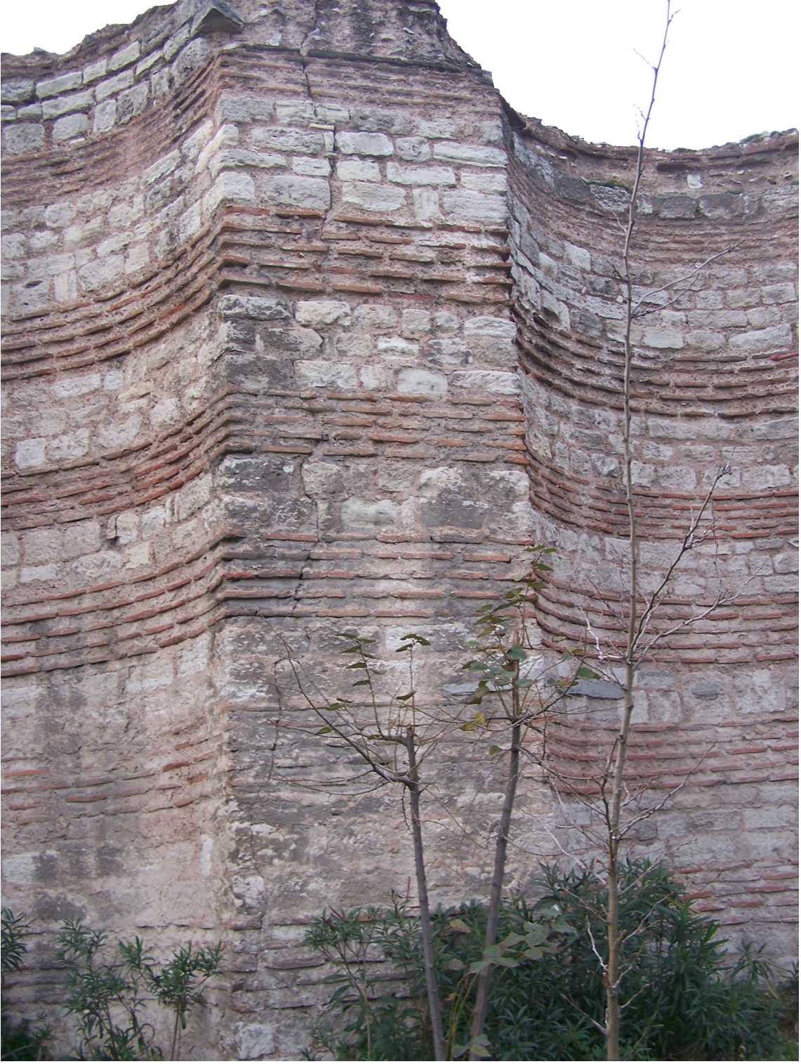
Şekil 4.79 Doğu duvarının dış cephesindeki 5. ve 6. nişler arasındaki duvarda oluşan çatlak (2007)
