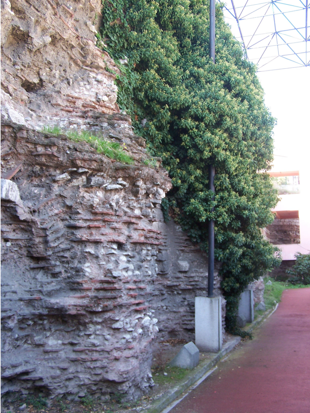
řekil 5.18 Güney duvarının i cephesindeki yoğun bitki oluřumu (2007)
