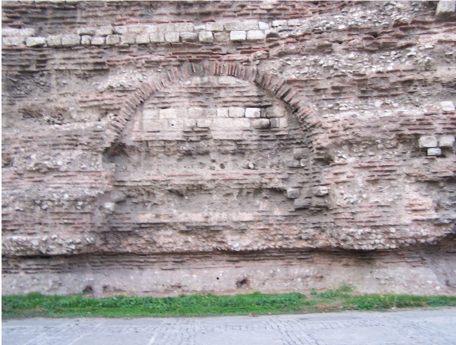
Şekil 4.33 Kuzey duvarının iç cephesindeki 2.-3. ayaklar arasındaki kemerin kalıntıları (2007)
