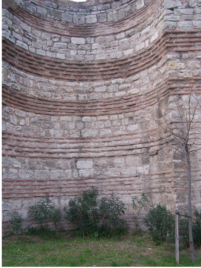
Şekil 5.16 Doğu duvarının dış yüzünde izlenen yüzeysel çatlak oluşumu (2007)
