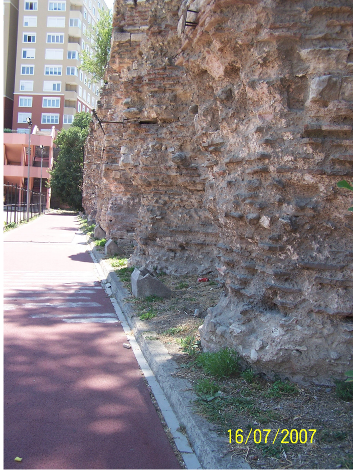
Şekil 5.8 Batı duvarının iç cephesinde 1.00 m derinliğe varan malzeme kaybı (2007)
