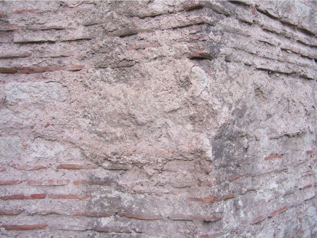
Şekil 4.125 Doğu duvarının dış cephesindeki 3. nişte görülen sıva kalıntısı (2007)
