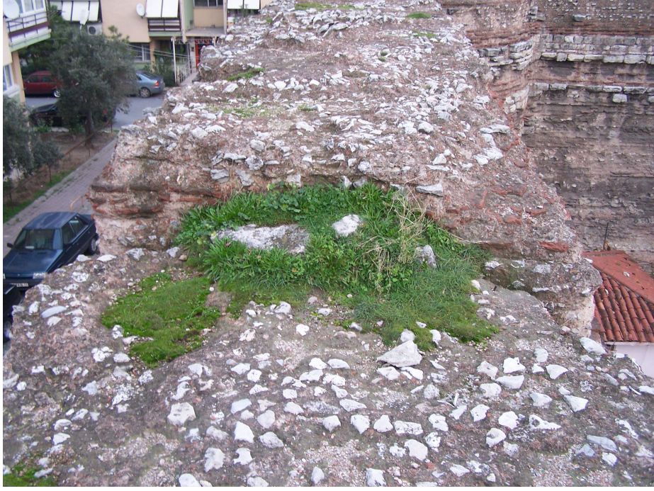
Şekil 5.19 Kuzey duvarının üst yüzeyinde çatlakların olduğu bölgedeki bitkilenme (2007)
