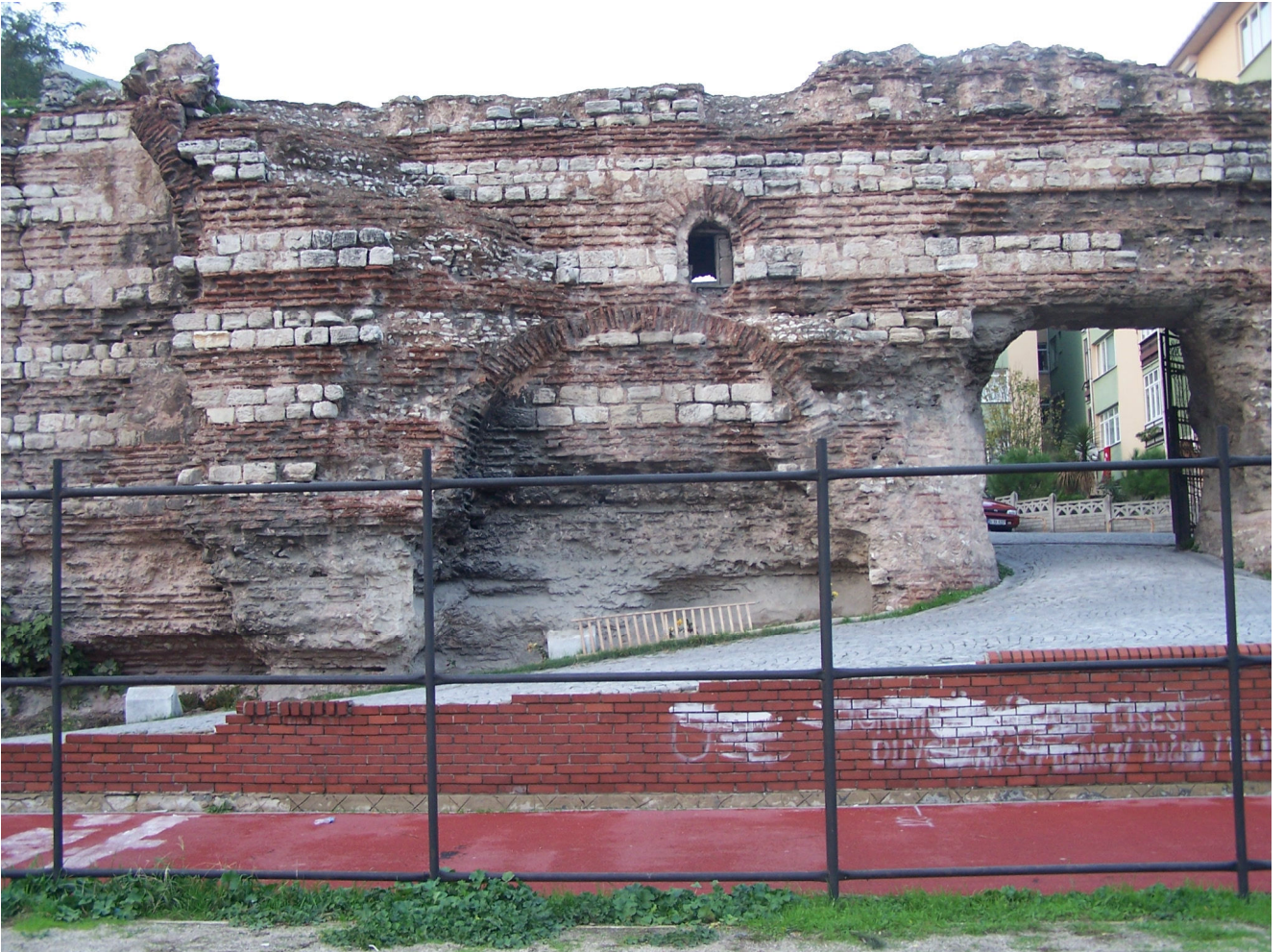
Şekil 4.35 Kuzey duvarının iç cephesindeki 4.-5. ayaklar arasındaki kemerin kalıntıları (2007)
