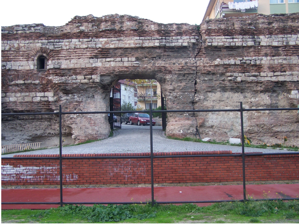
Şekil 4.47 Kuzey duvarının iç cephesindeki 3. çatlak (2007)
