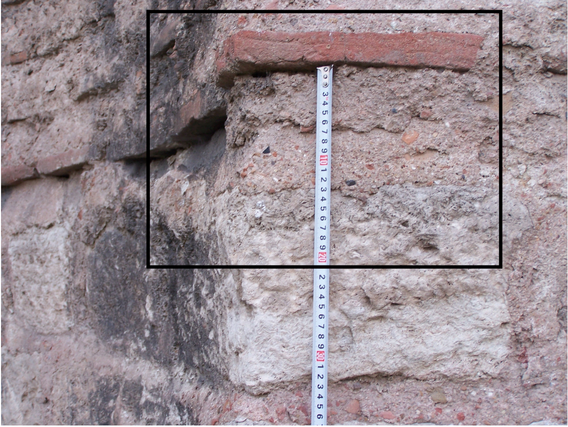
Şekil 4.126 Doğu duvarının 10. nişindeki tuğla hatıda görülen 12 cm'lik derz (2007)
