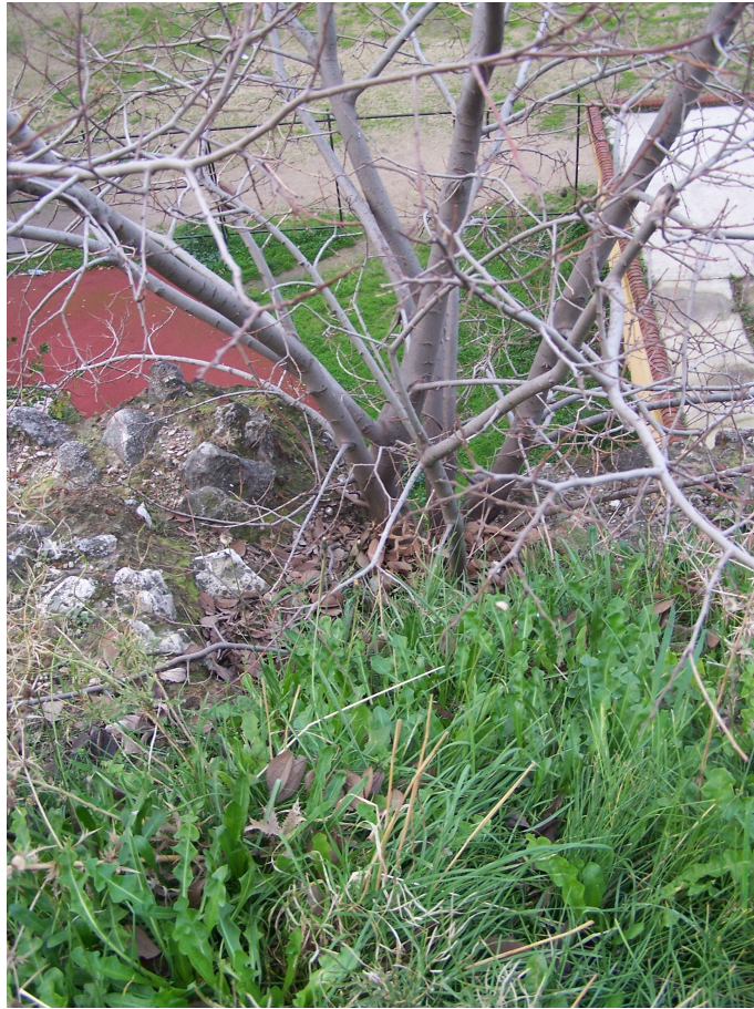
Şekil 5.6 Güney duvarının iç cephesindeki çatlak içinde köklü bitki oluşumu (2007)
