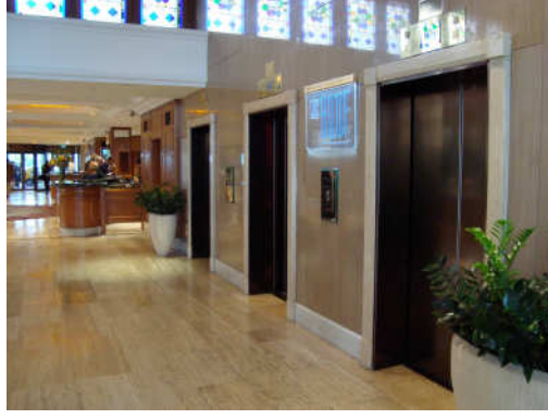
Şekil 6.17 Yatak katlarına ulaşım sağlayan otel asansörleri
