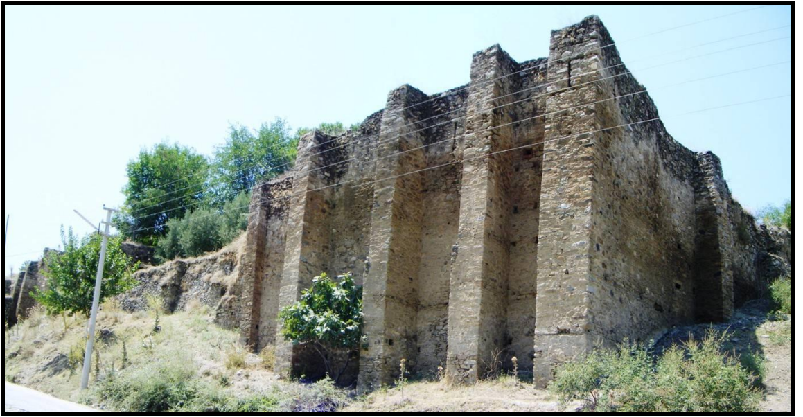
Şekil 2.10 Cincin Kulesi güney istinat duvarları (Hürol, Ağustos 2010) Üst kottaki toprak dolgu ve tarım amaçlı sulama kale duvarlarında çatlak ve rutubete bağlı bozulmaya neden olmuştur.
