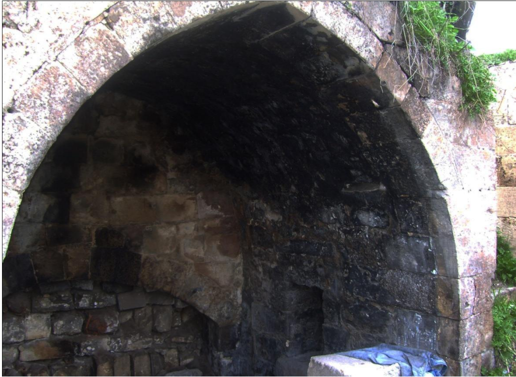
Şekil 6. 80 Mutfak mekânının duvarları ve bozulmalar, (Şanlıurfa, Nisan 2009)
