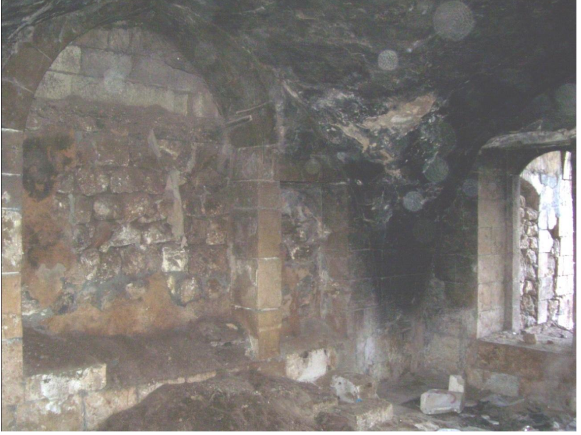
Şekil 6. 89 ZK-10 Nolu mekânın görünümü, bozulmalar ve duman lekeleri, (Şanlıurfa, Nisan 2009)
