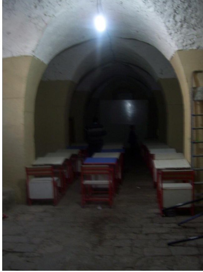
Şekil 4. 42 Kurtuluş İlköğretim Okulu zemin katta yer alan kantin, çapraz tonozlu tavanı, (Şanlıurfa, Nisan 2011)
