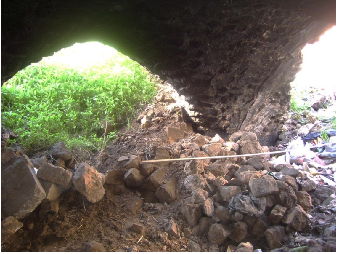
Şekil 6. 82 ZK-03 Nolu mekânın görünümü, yıkıntılar ve çöpler, (Şanlıurfa, Nisan 2009)
