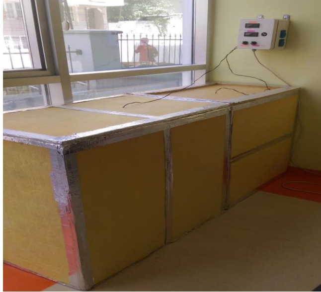
Şekil 3.19 Otomatik Kontrol tablosunun duvara montajı ve deney setine eklenmesi
