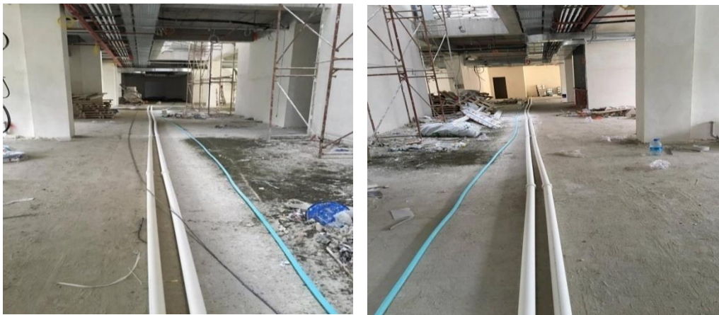
Şekil 5. 28 Toprak ve Beton hatları uygulamalarına ait dönüş hatlarının görünümü
