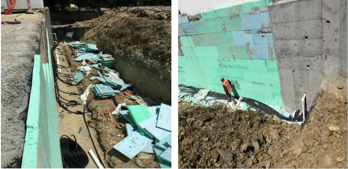
Şekil 5. 24 Toprak ve Beton hatlarına ait kolektör bağlantılarının görünümü
