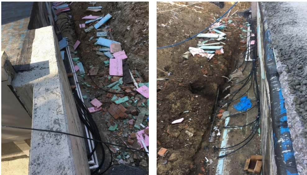
Şekil 5. 20 Bina ana giriş kapısının olduğu bölümde Toprak ve Beton hatlarının kaplin bağlantılarının görünümü
