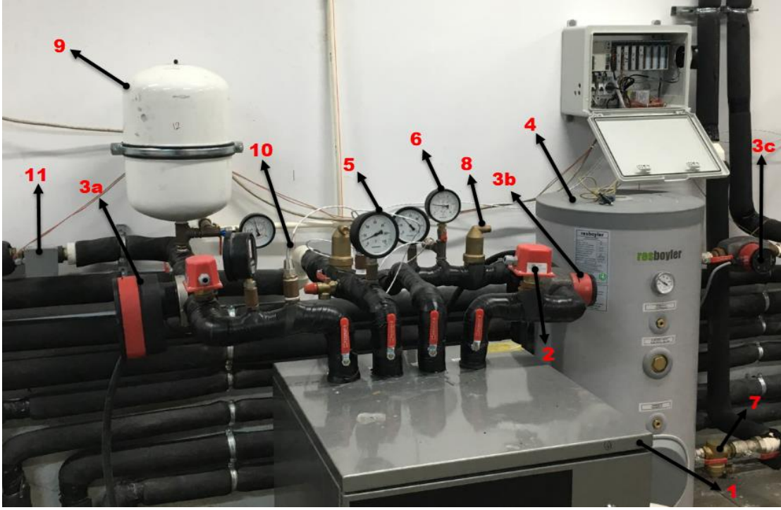
Şekil 5. 35 Bir ısı pompası üzerindeki ekipmanlar
