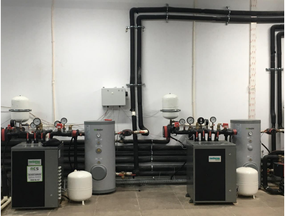
Şekil 5. 34 Isı pompası tesisatının grup halinde görünümü
