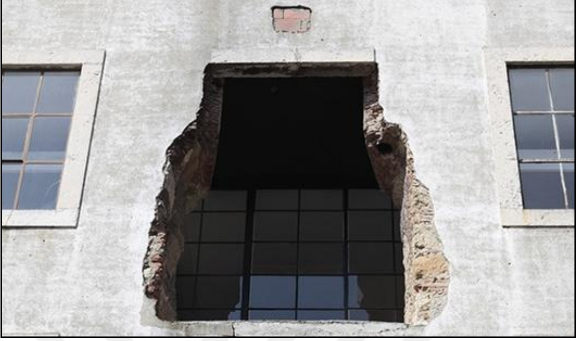
Şekil D.15 Cephede korunmuş hasar izi [145]
