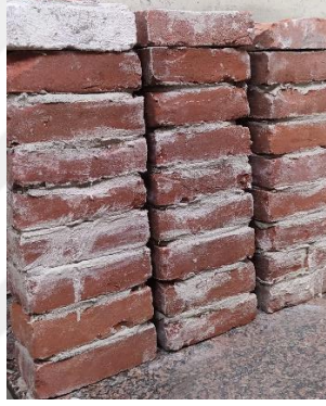
Şekil 4. 8 Güçlendirilmemiş yığma kirişler.
