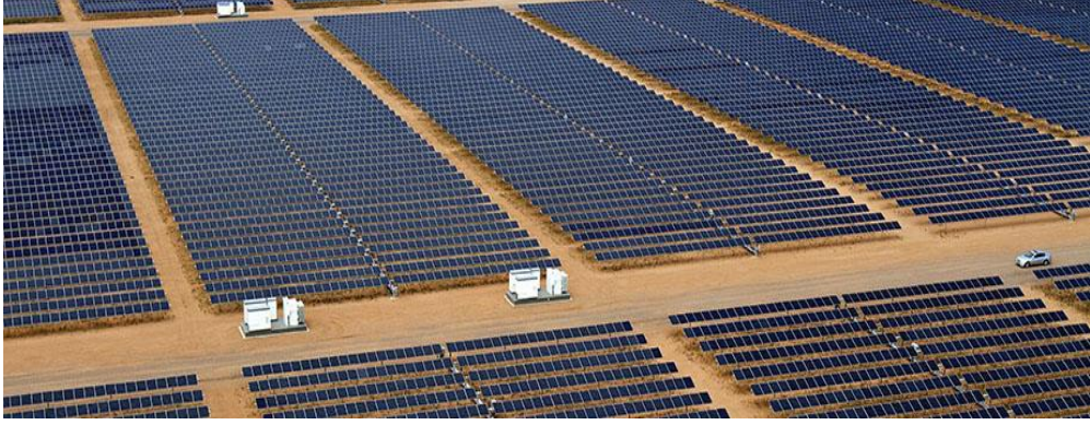
Şekil 2. 9 Fotovoltaik güneş pili tarlası
