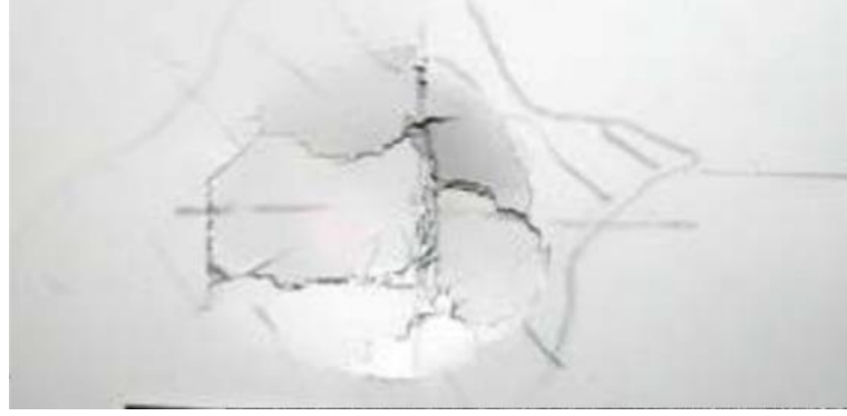
Şekil 2.22 Uçağın dış yüzeyinde görülen hasar [35]
