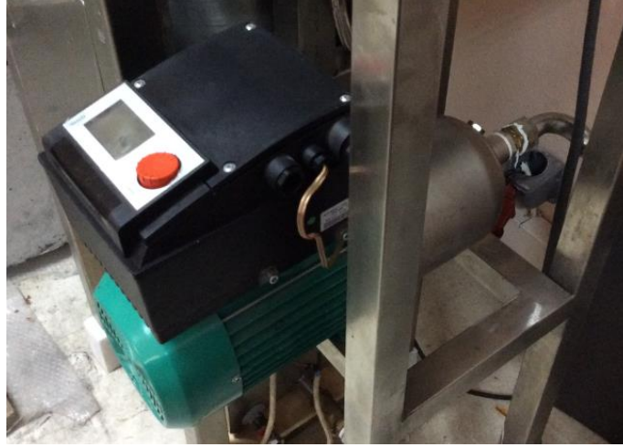
Şekil 2.10 Seçilen frekans konvertörlü su pompası
