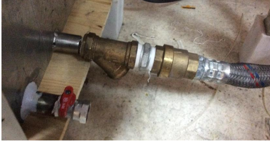
Şekil 2.17 Hazne boşaltma vanası, pislik tutucu, check valf ve flex borusu
