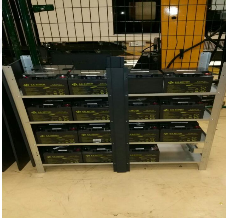
Şekil 5. 16 Batarya kabini imalatı ve montajı
