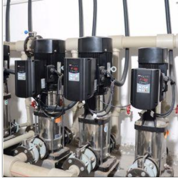
Şekil 4. 22 VSD yöntemiyle kontrol edilen bir pompa grubu
