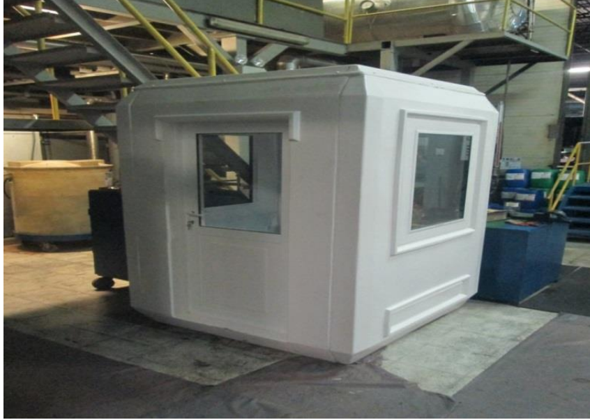
Şekil 6.12 Kazan dairesinde çalışanlar için kabin
