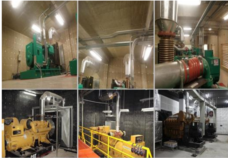
Şekil 5.12 Jeneratör odası içten ses yalıtım ve izolasyon uygulamaları
