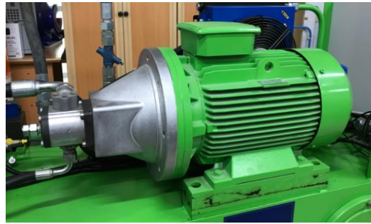
Şekil 4. 3 Deneyde kullanılan AC asenkron elektrik motoru ve dişli pompa
