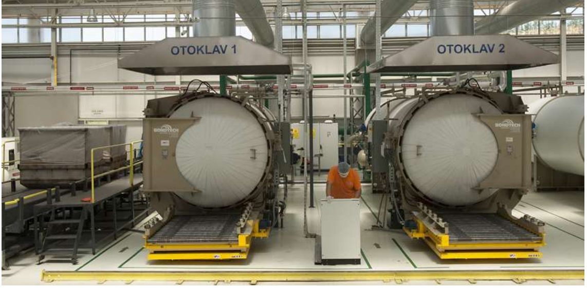
Şekil 2.8 Tıbbi atık sterilizasyon tesisi
