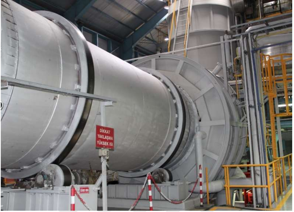
Şekil 2.9 Tıbbi atık yakma tesisi
