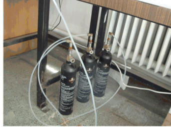
(b) Hidrojen depolama ünitesi
