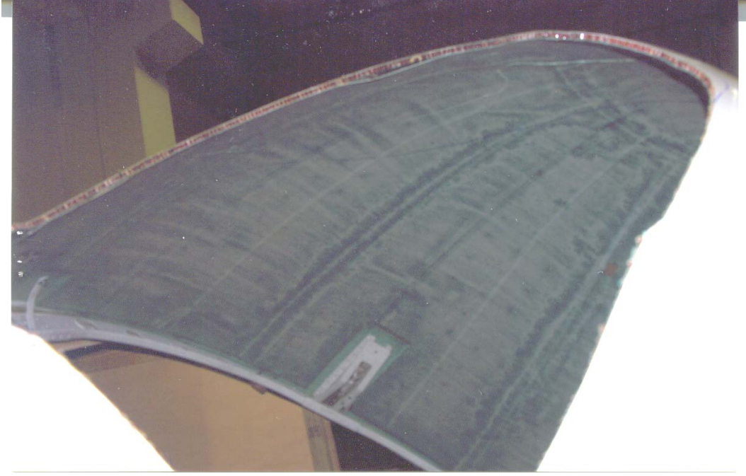
Şekil 7.108 Airbus 320 uçağının hasarlanmış bölümünde petek yapının ve iç yüzeyin görünümü
