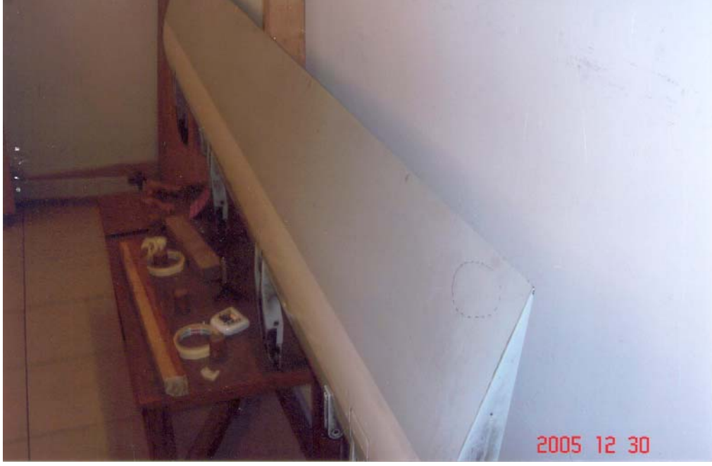
Şekil 7.97 Hatalı bölüm gözle, tap testi ve X-ışınlarıyla tesbit edilerek delaminasyon ve korozyon tesbit edilmiştir
