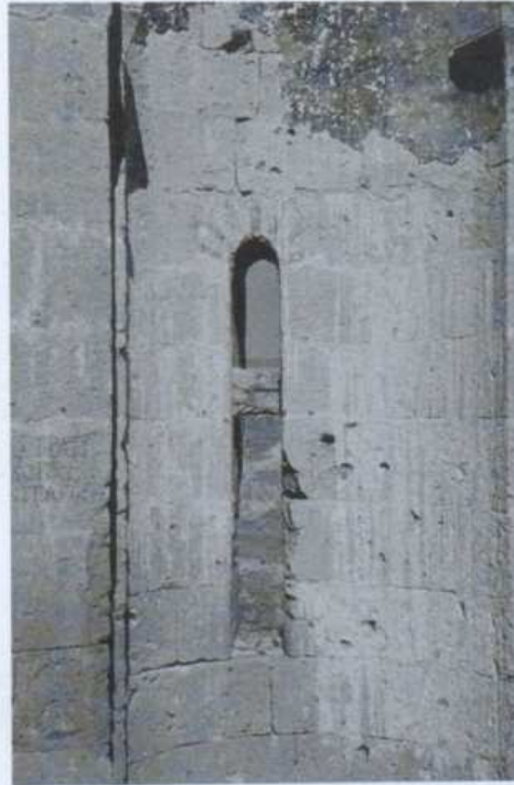
Resim 3.126 Çanlı Kilise, güney yan apsis penceresinde ahşap hatıl
