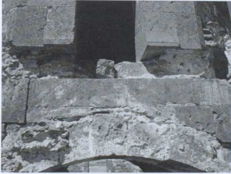
Resim 3.59 Kızıl Kilise, çatı kaplaması izi
