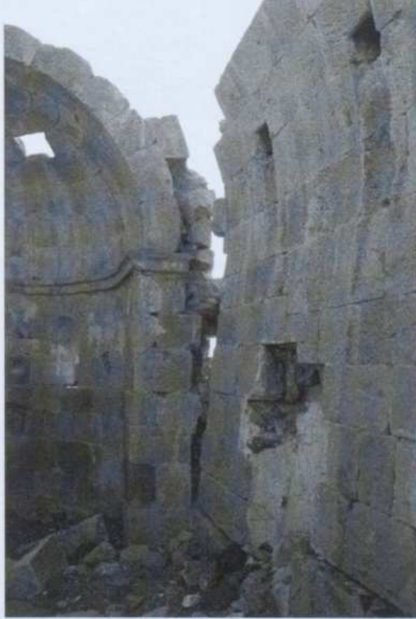
Resim 3.7 Anatepe Kilisesinin güney duvarındaki açılma
