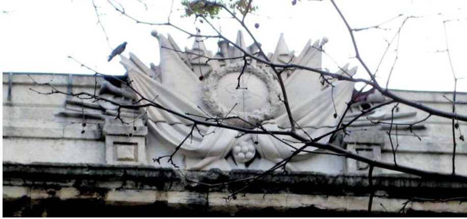
Şekil 3.211 Maçka Silahhanesi'nin çatı parapetinde bulunan Abdülaziz'in tuğralı arması (2010)
