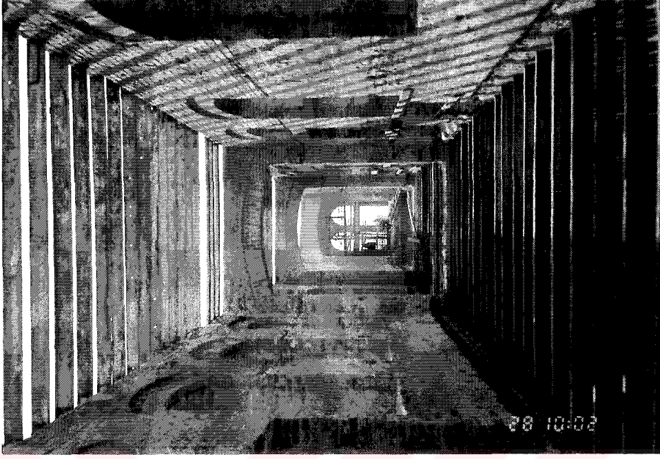
Resim 3.153 Sultanahmet Cezaevi, yatay taşıyıcı volta döşeme
