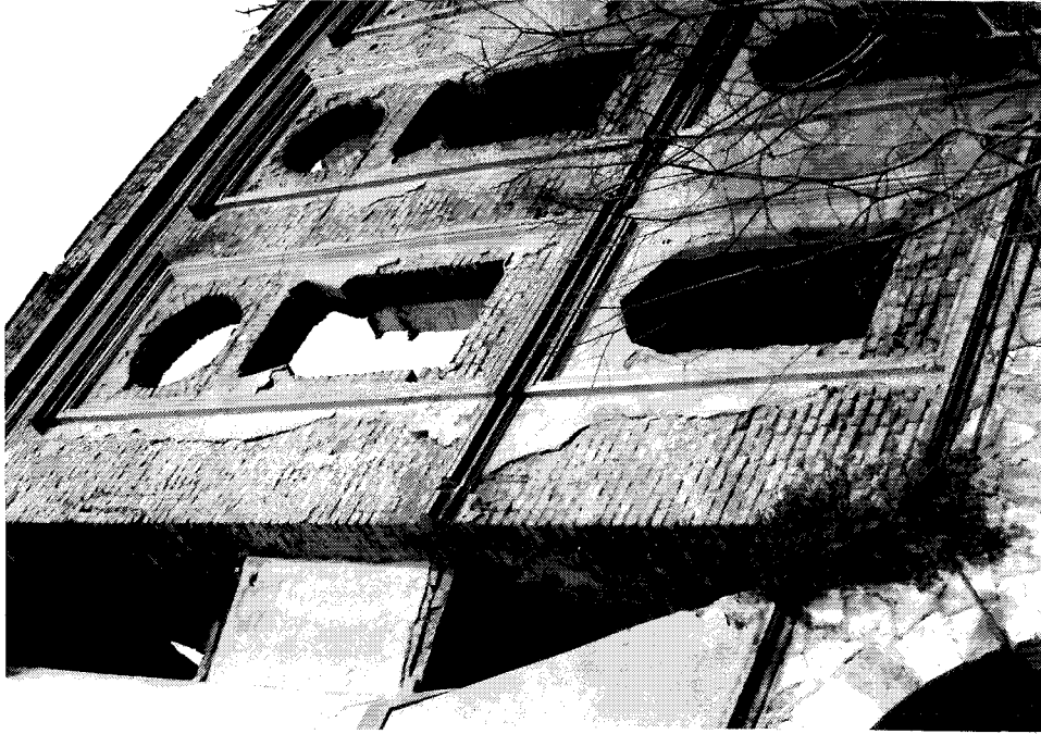
Resim 3.124 Buhara (Özbek) Tekkesi yığma tuğla düşey taşıyıcı ve metal kuşaklama
