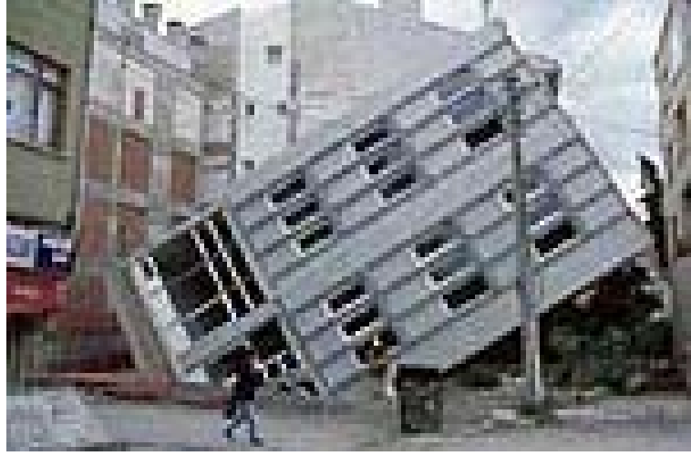
Şekil 4.11 1999 Gölcük depremi nedeniyle oluşan sıvılaşmanın yol açtığı taşıma gücü kaybının Adapazarı'nda bir binaya etkisi ( www.learn-hazards.org )
