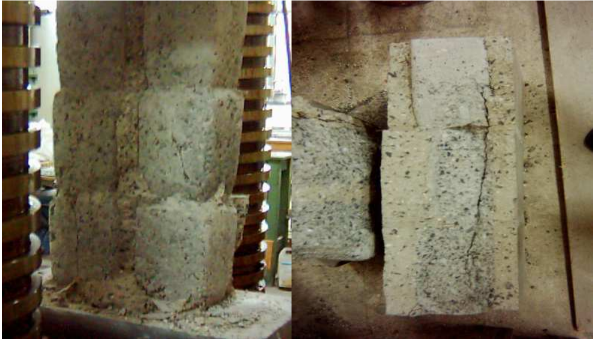
Şekil 7.32 Dolgu betonunda meydana gelen boyuna çatlaklar.
