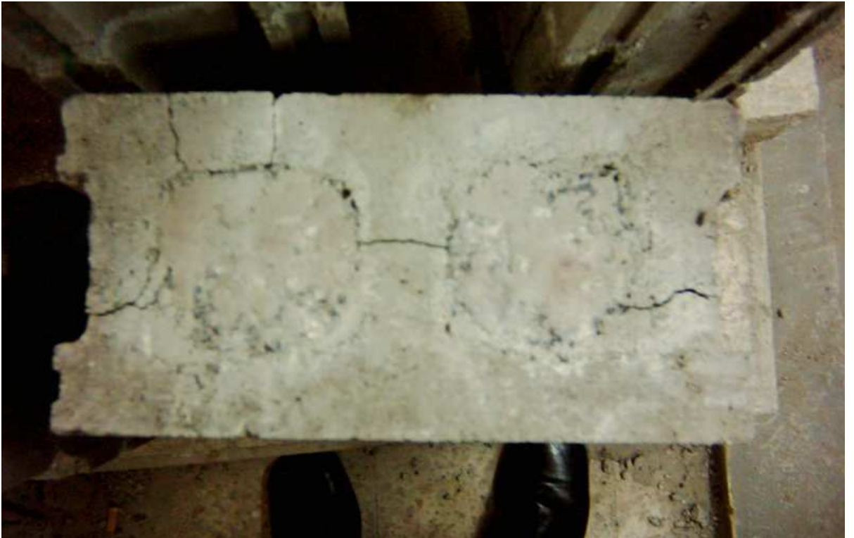
Şekil 7.30 Prizmaların dış ve orta kabuklarında oluşan düşey çatlakların üstten görünüşü.
