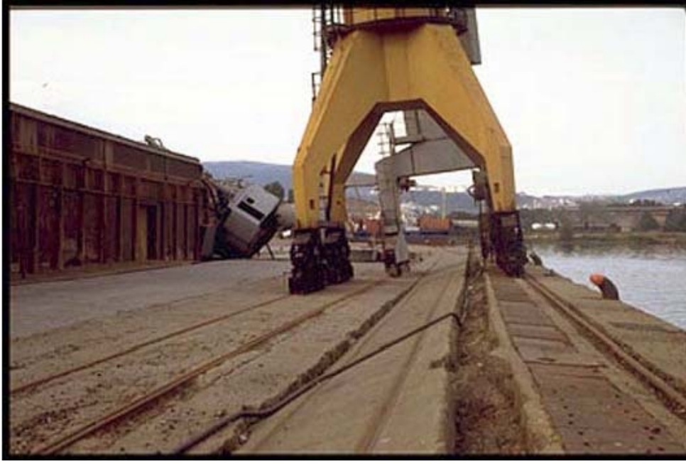
Şekil 1.2 Derince Limanı Kocaeli Depremi 1999 Sıvılaşma nedeniyle oluşan deformasyon [25]
