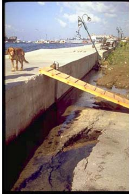
Şekil 1.3 İzmit Marina. Kocaeli Depremi(1999). Sıvılaşma nedeniyle oluşan oturma[25]
