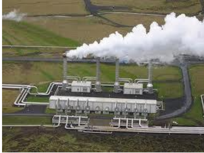
Şekil 2.5 Jeotermal enerji santrali
