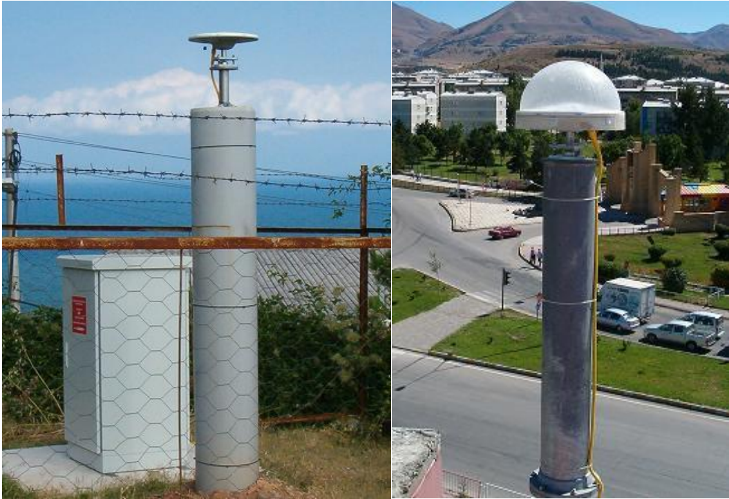
Şekil 2.3 Zemine tesis edilmiş CORS İstasyonu ve çatıya tesis edilmiş CORS İstasyonu
