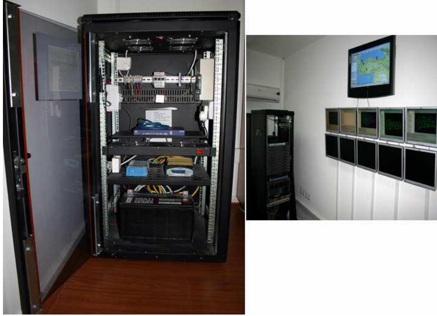
Şekil 2. 5 TKGM Kontrol Merkezi
