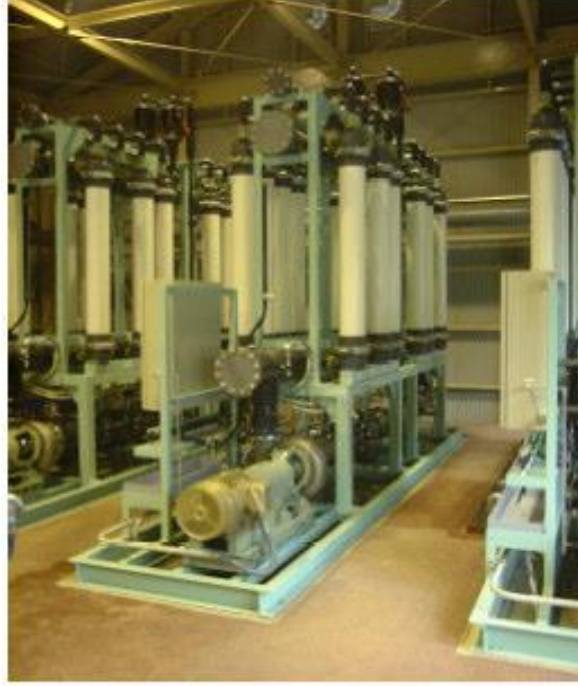
Şekil 3. 9 Sasakura çöp sızıntı suyu arıtma tesisinde kurulan nanofiltrasyon üniteleri [4]
